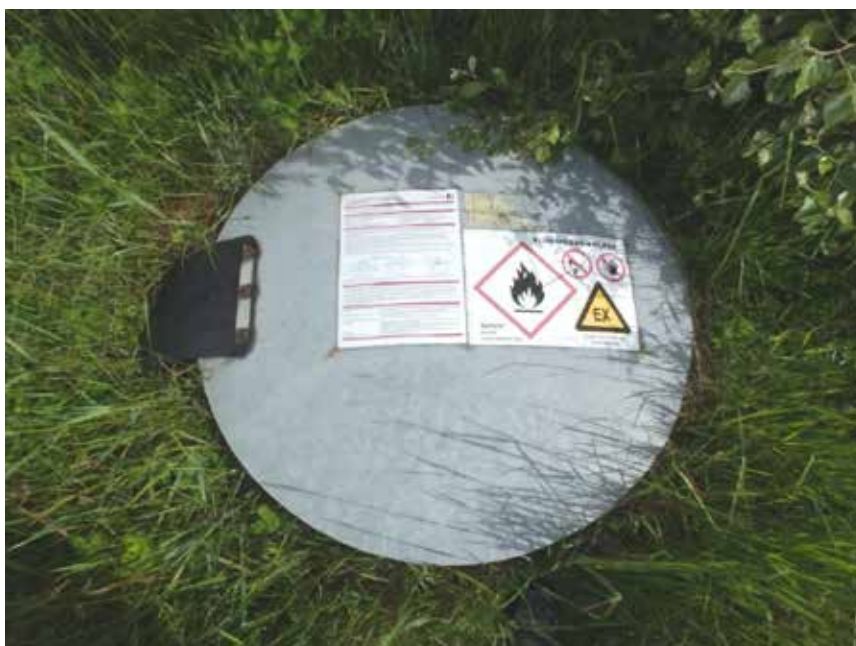
Bild 22: Deckel zu Flüssiggastank
