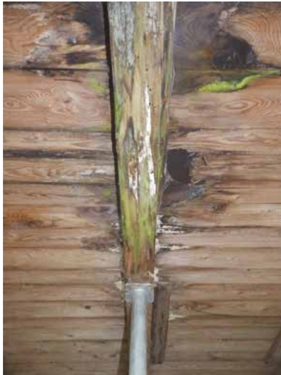
Bild 13: Decke in Wirtschaftsschuppen (stark schadhaft, Seite zu Bewertungsobjekt gehörend)
