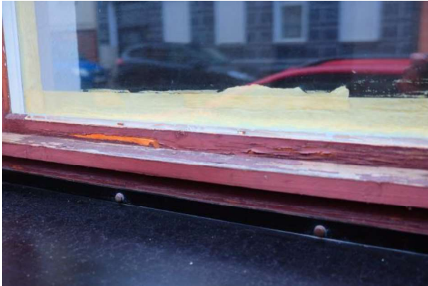
Ältere Holzfenster, verwitterte Holzrahmen
