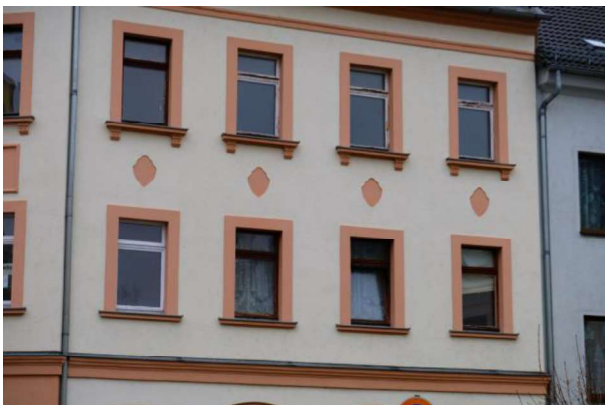
Putzfassade mit Fensterlaibungen, Holzverbund- fenster mit Einfachverglasung, ältere Fenster, Holzrahmen z. T. schadhaft
