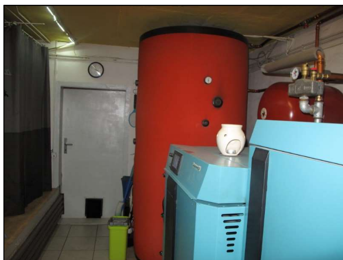
Blick auf die Pelletheizung
