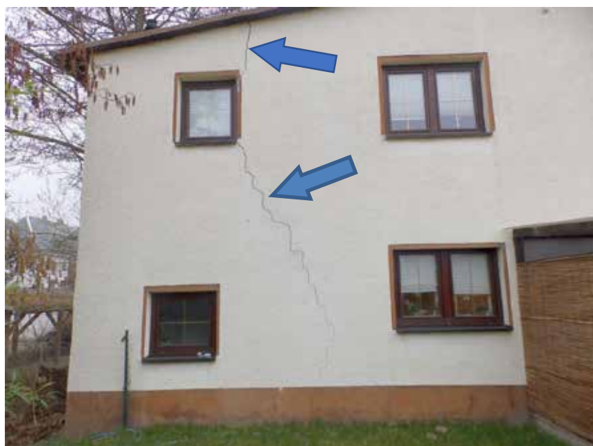
Bild 8: Detailansicht der Fassade (Westseite), mit Setzungsriss
