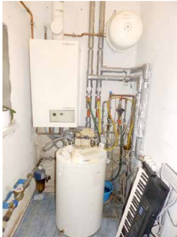
Bild 11: Heizungsraum des Wohngebäudes
