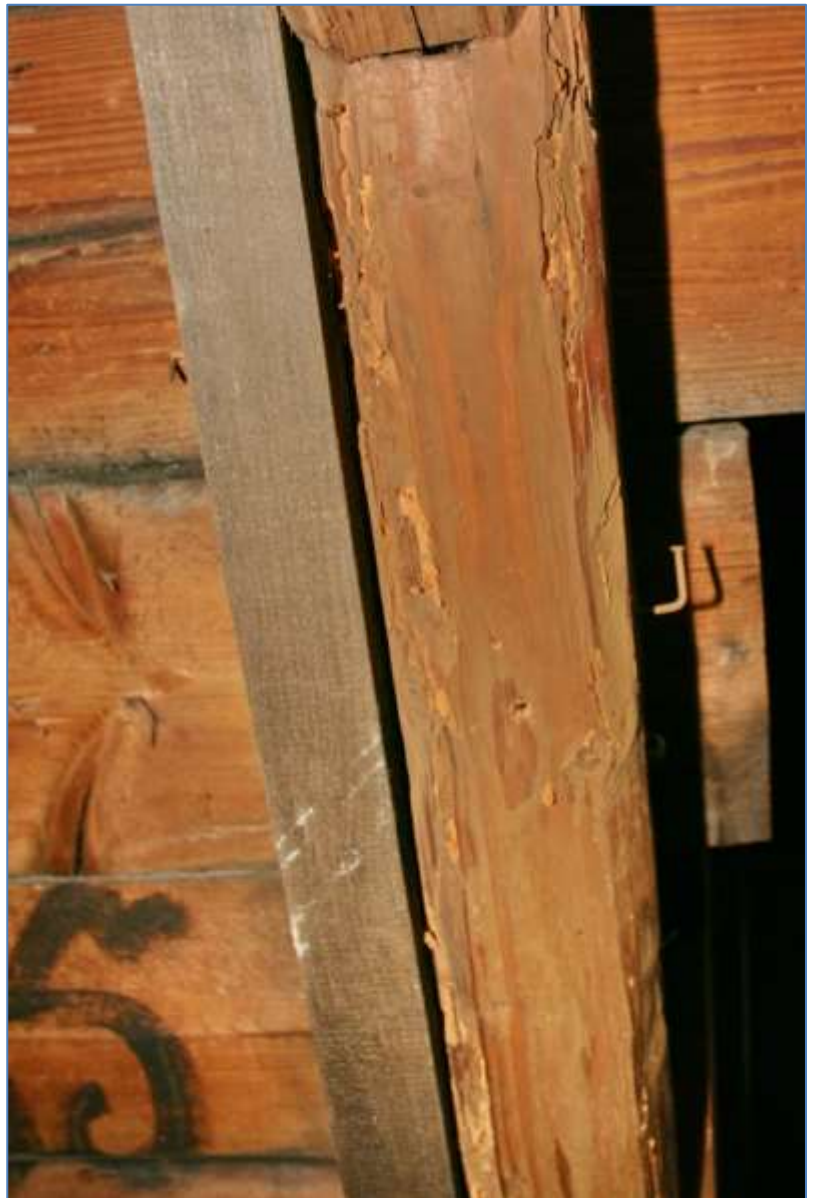
Bild 24 Detail Holzschädlingsbefall am Dachtragwerk
