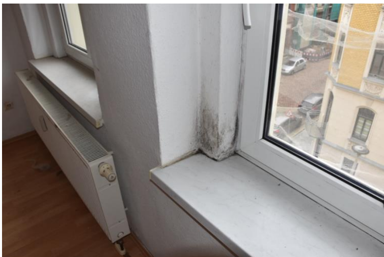
Foto 6: Innenaufnahme Detail Fensterleibung – Schimmelbildung
