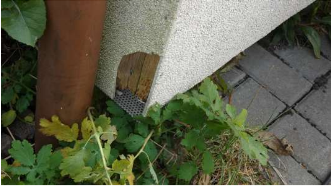
Fassade – Detail; defekter Außenwandbereich (Wärmedämmung aus Holz sichtbar)
