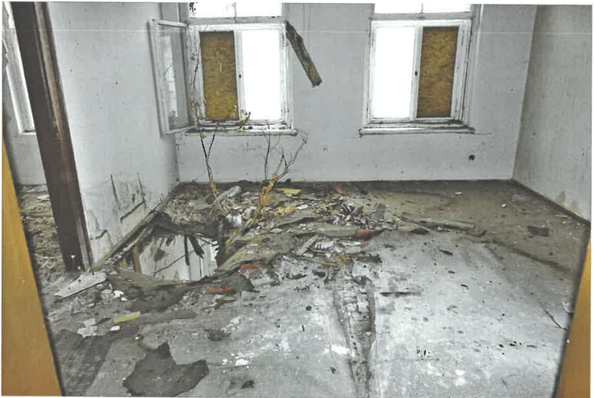
III.OG, südwestliches Zimmer zur Straße (mit analogem Deckendurchbruch zum DG - nicht auf Foto zu sehen)
