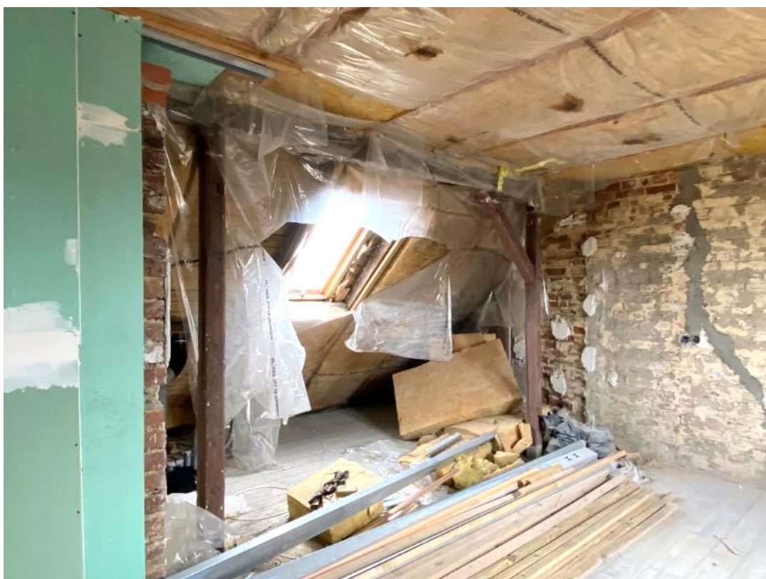
Bild 27, Dachboden, an der Decke sind auf der „Dampfsperre“ Wasserflecken erkennbar
