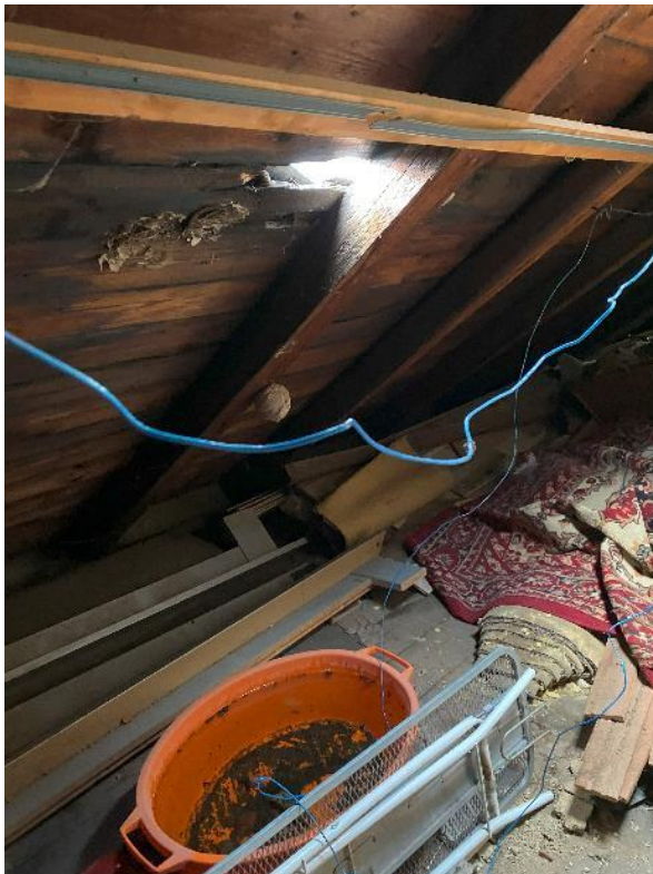
Bild 30, Schaden am Dach
