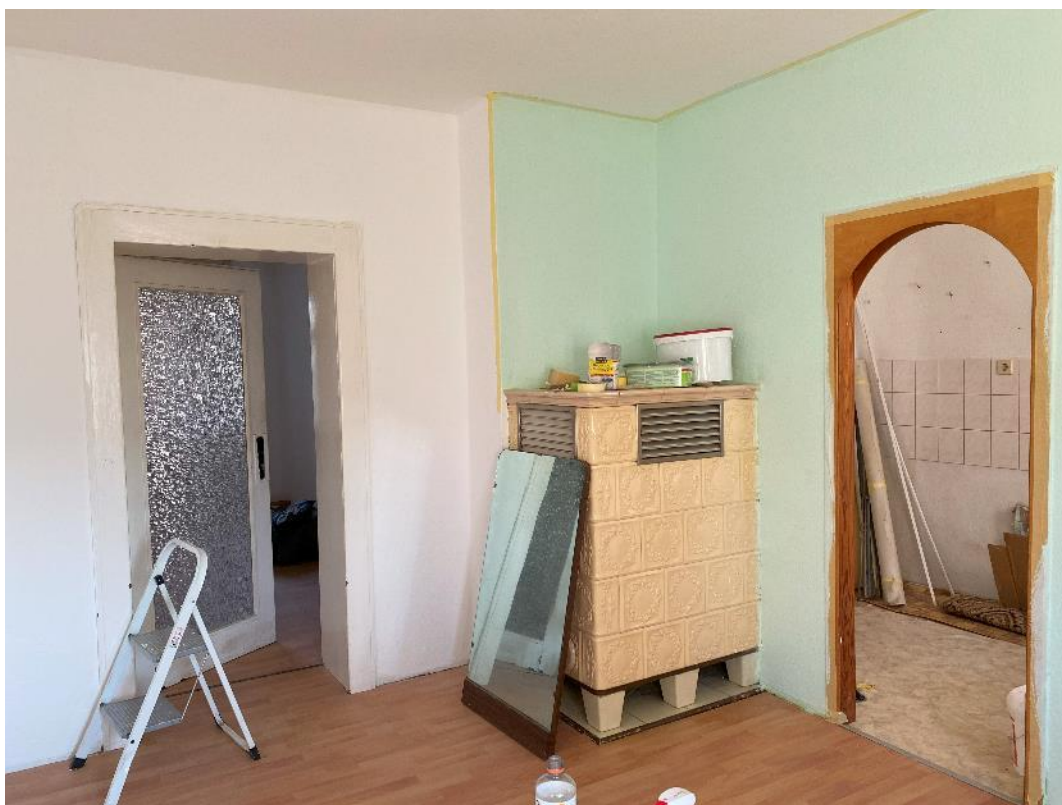
Bild 11, Wohnraum mit Durchgang zur Küche (Kachelofen-Warmluftheizung nicht funktionsfähig wegen abgetragem Schornstein)
