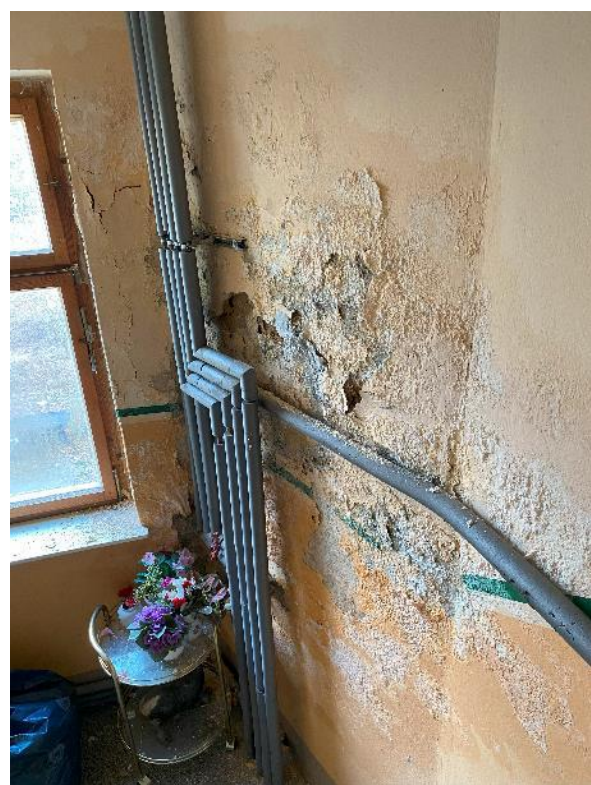
Bild 10, typisches Schadensbild an den Treppenhauswänden im Bereich sämtlicher Leitungsdurchführungen
