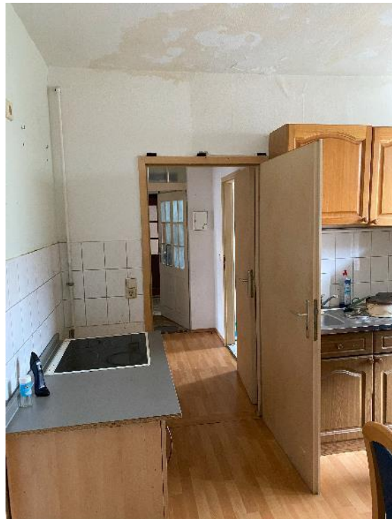
Bild 19, Wasserschaden in der Küche
