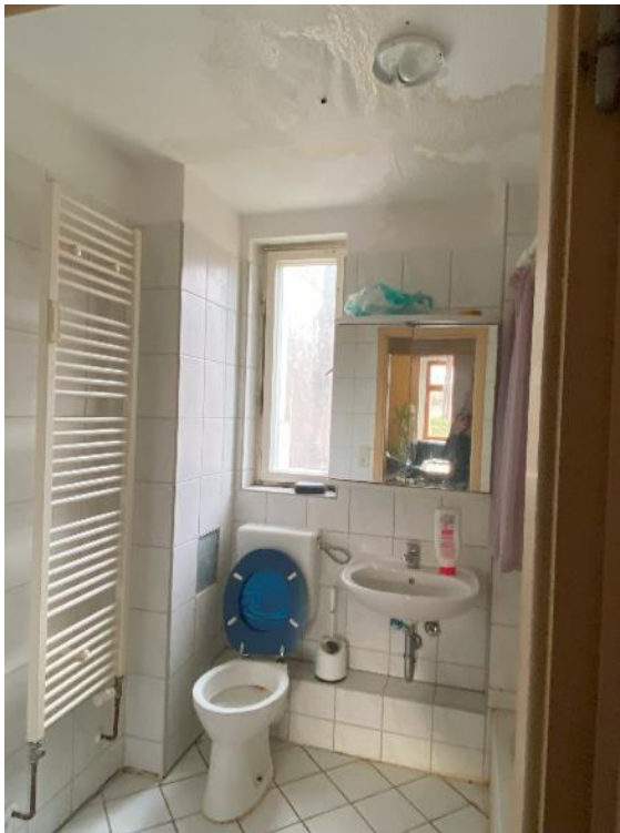
Bild 18, Wasserschaden im Bad
