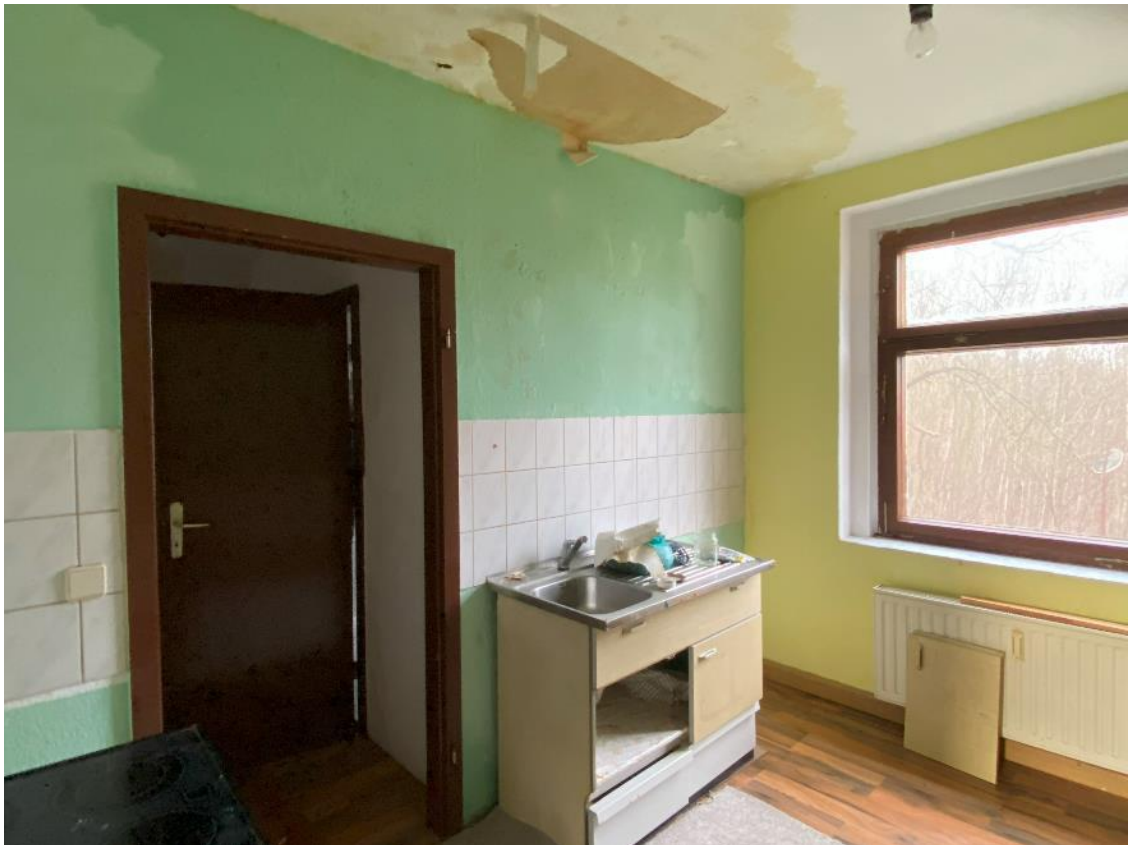
Bild 27, Küche mit Wasserschaden
