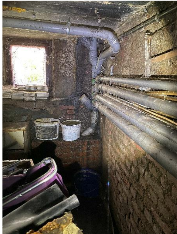
Bild 32, Abwasser-, Heizungs- und Warmwasserleitungen
