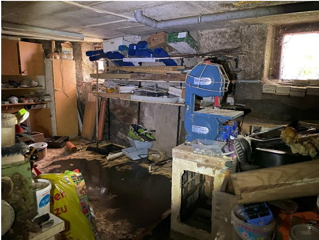
Bild 35, Kellerraum mit durchnässtem Fußboden
