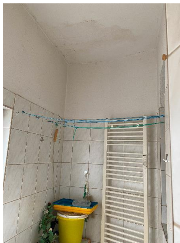
Bild 20, von der Küche aus zugänglicher Waschraum mit Wasserschaden an der Decke
