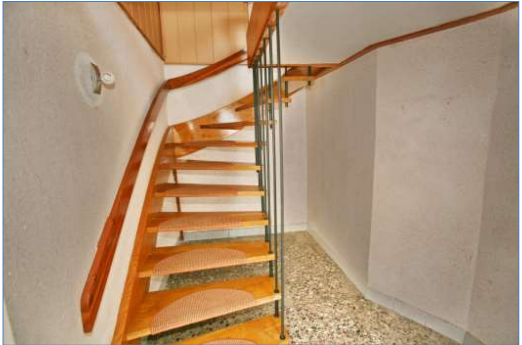
Bild 6 Feuchteschäden im Erdgeschoss
