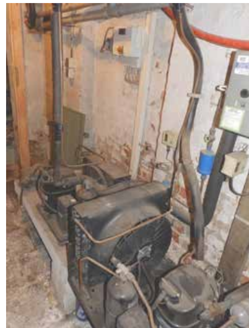
Bild 20: Kellergang (mit Kühlanlagen)
