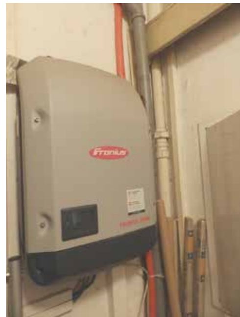
Bild 28: Wechselrichter der PV-Anlage
