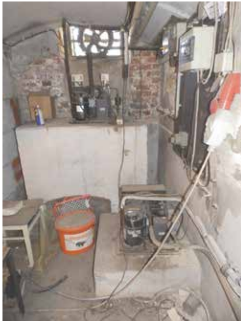
Bild 21: Kellerraum (mit Kühlanlagen)
