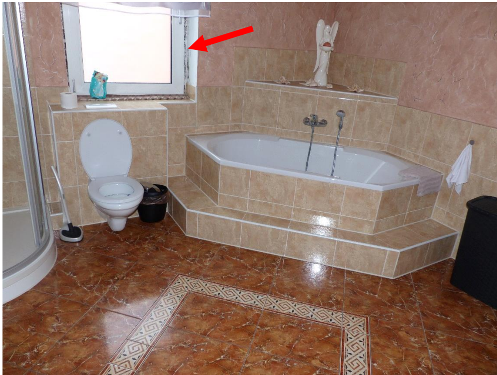
Bad im Obergeschoss; rot: starker Schwarzsimmelbefall (an fast allen Fenstern im Obergeschoss)
