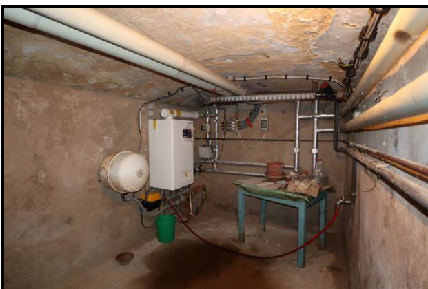
Heizraum im Keller
