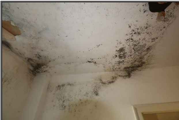
Schimmelbildung an der Zwischendecke der OG-Wohnung
