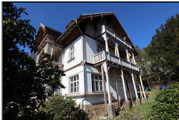
Ost-Ansicht des Bewertungsobjekts mit abgestütztem Balkon
