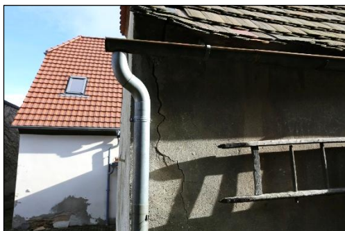
Rissbildungen an einer Gebäudeecke der Scheune
