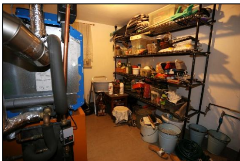
Blick in den Heizungsraum im EG
