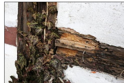
Auch dieses weist tlw. größere Mängel und Schäden auf
