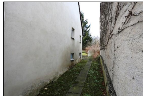
Abstand zwischen den Nachbarbebauungen tlw. sehr gering. Feuchtigkeit im Sockelbereich erkennbar.
