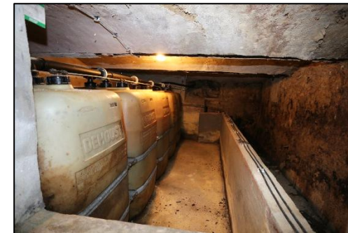
Tanklager im Keller
