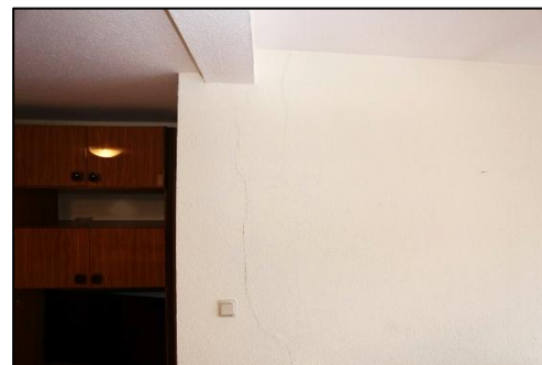
Rissbildung im Anschlussbereich des Anbaus an das Hauptgebäude
