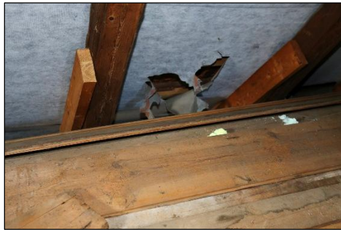
Schäden an der Unterspannbahn
