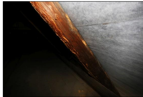
Augenscheinlicher Schädlingsbefall (es wurden keine tiefgreifenden Untersuchungen angestellt)
