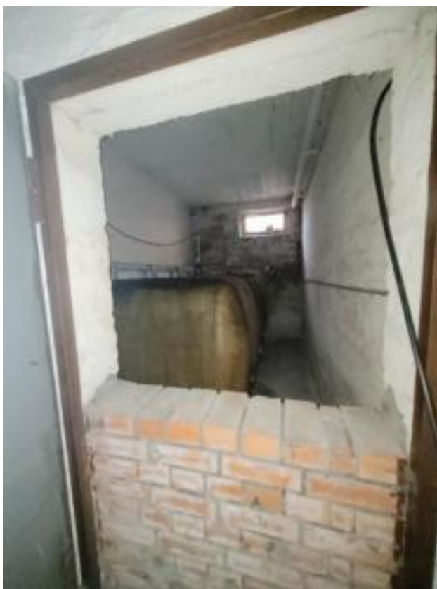
Öltanks im Kellergeschoss
