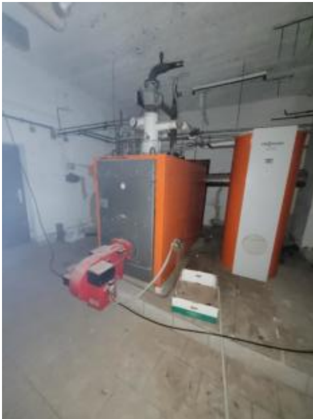
Heizungsanlage im Kellergeschoss
