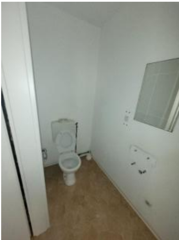
WC der ehemaligen „Salzgrotte“
