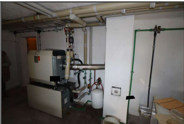
Heizung im KG des Wohnhauses
