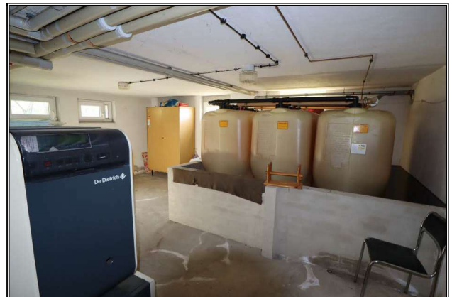
Öltanks im KG des Wohnhauses
