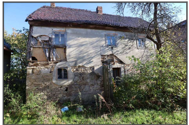
West-Ansicht des baufälligen Fachwerkhauses
