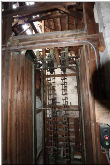
Teil des Lastenaufzuges
