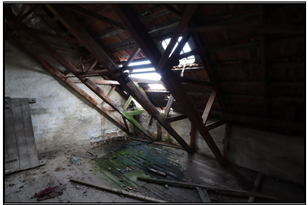
Teil des Dachbodens; starke Feuchte- und Bauschäden
