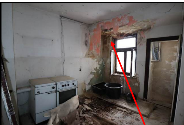
Ansicht eines Zimmers im DG mit durchgebrochener Decke
