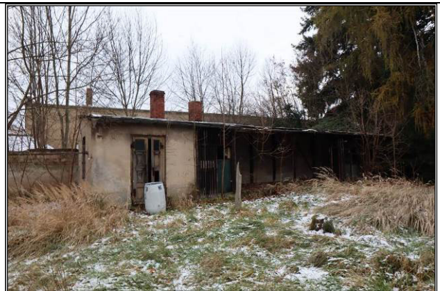
maroder Schuppen im nordwestlichen Grundstücksbereich
