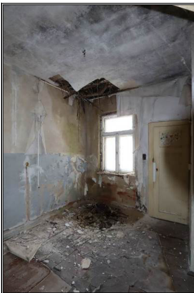
Zimmer einer Wohnung im 2.OG mit durchgebrochener Decke
