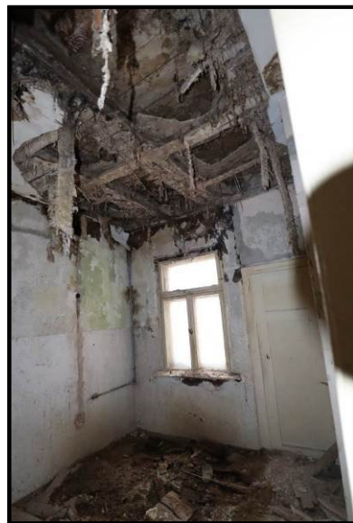
Zimmer einer Wohnung im 1.OG mit durchgebrochener Decke
