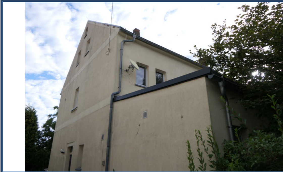
Abbildung 5: Süd-West-Ansicht (Nebeneingang); verwilderte Außenanlagen
