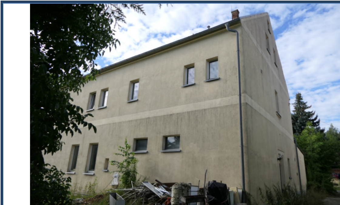
Abbildung 4: Nord-West-Ansicht; verwilderte Außenanlagen; Unratablagerungen
