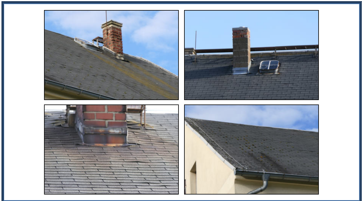
Abbildung 8: Detailansichten der Dacheindeckung; beschädigter Schornstein
