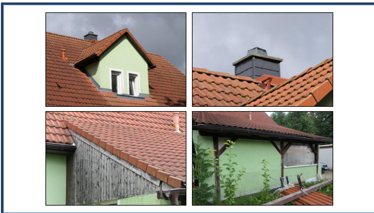
Abbildung 6: Detailansichten; tlw. verwitterte Holzbauteile
