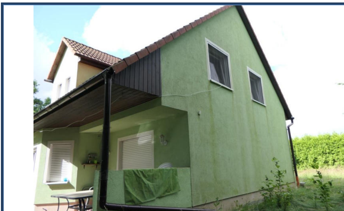
Abbildung 4: Giebel- und Rückansicht des Einfamilienhauses (Nord-Ost-Ansicht); tlw. verschmutzte Fassade; Außenanlagen
