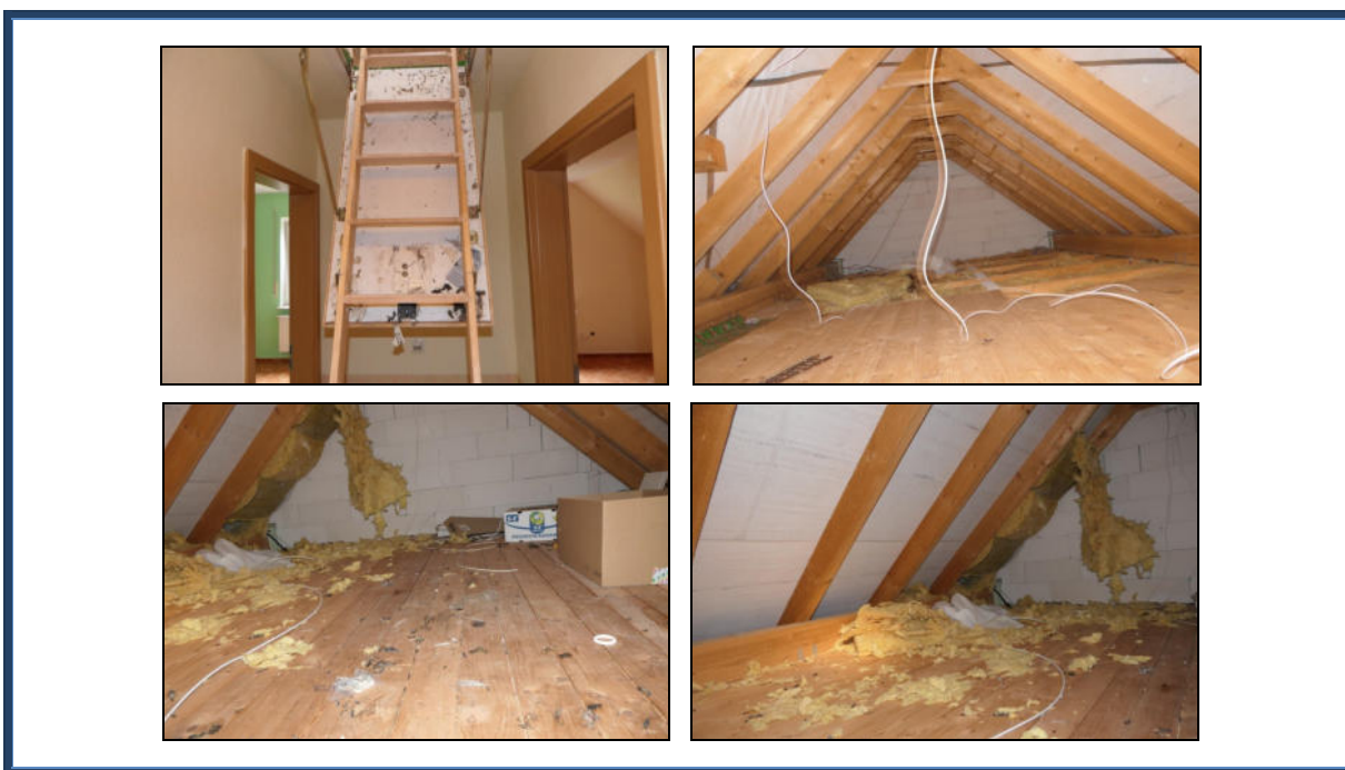
Abbildung 21: Flur im Dachgeschoss mit Zugang zum Spitzboden; Abstellbereich im Spitzboden; tlw. beschädigte Dämmung
