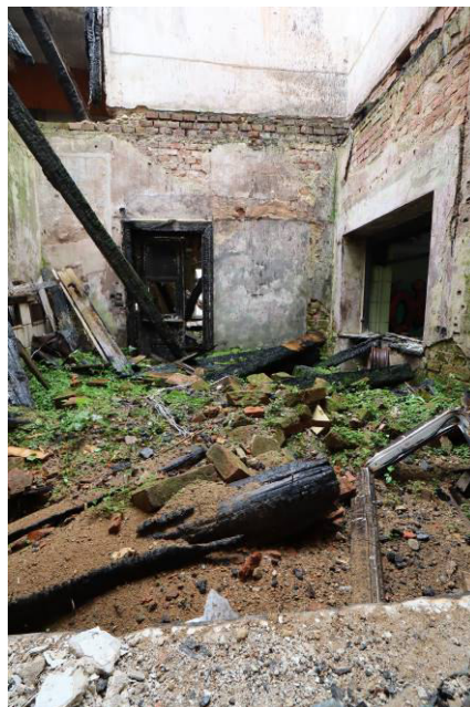
Gebäudeschaden nach Brand
