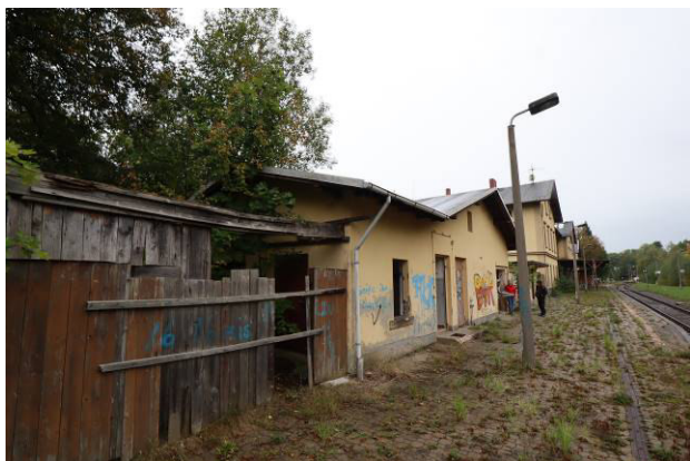
Detailansicht des abbruchreifen Nebengebäudes
