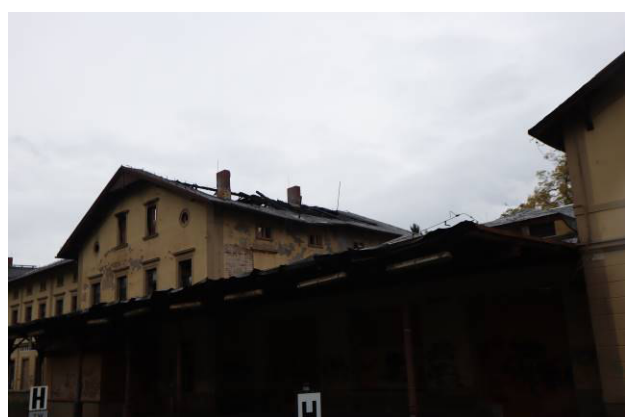
Süd-West-Ansicht des Brandschadens am Dach
