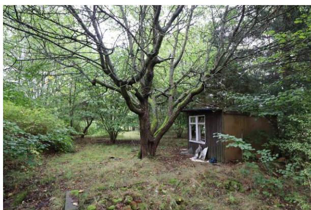
Detailansicht des abbruchreifen Holzschuppens
