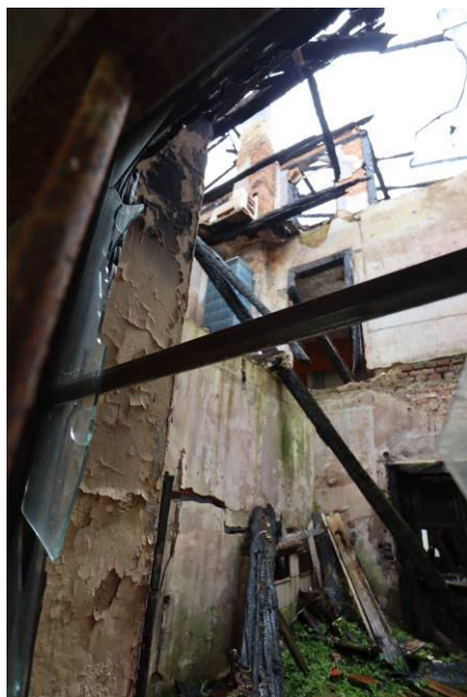
Gebäudeschaden nach Brand
