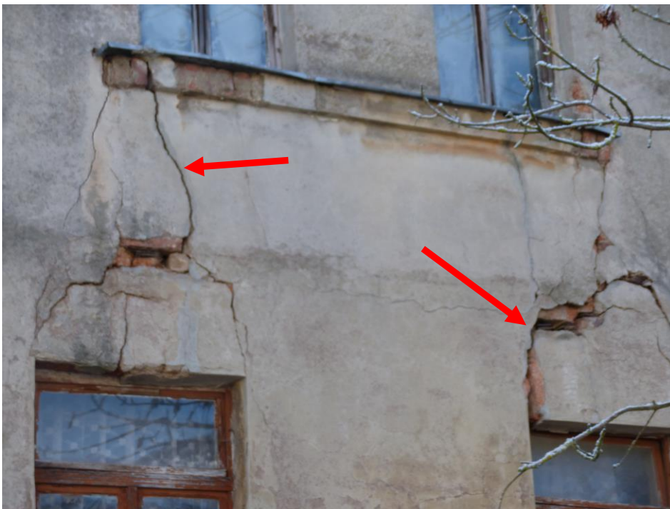
Westgiebel mit erheblichen Mauerwerksrissen
