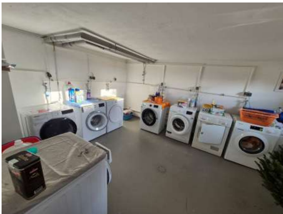
Waschmaschinenraum im Keller
