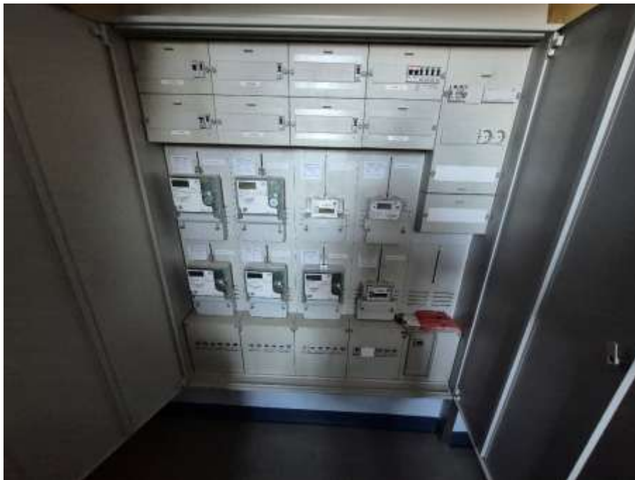
Elektroanschlusskasten im Kellergeschoss des Wohnhauses
