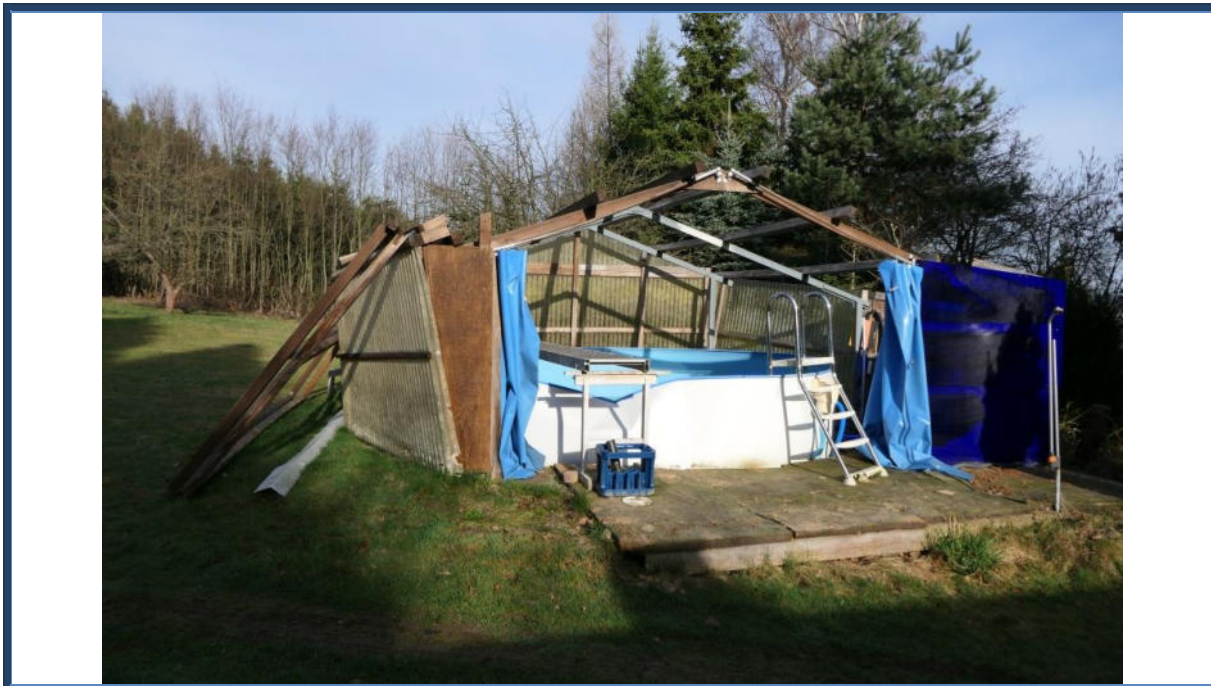
Abbildung 7: Handelsüblicher Pool mit beschädigter Überdachung; Außenanlagen
