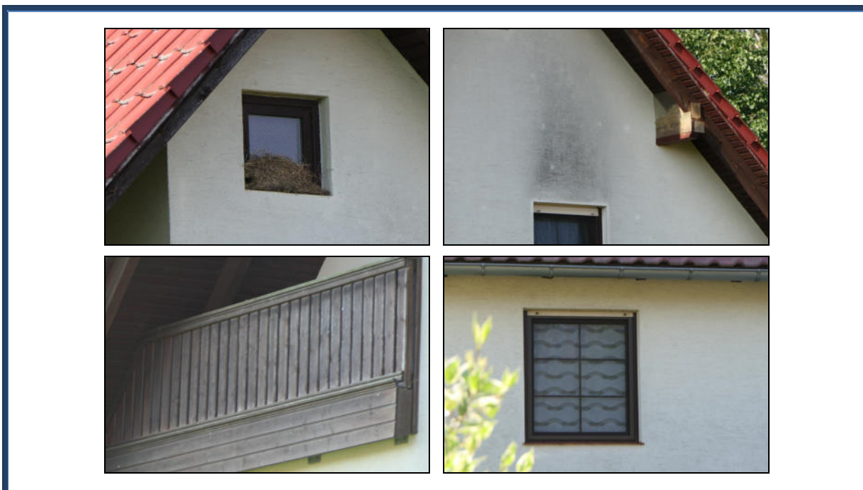
Abbildung 10: Detailansichten der Fassade (tlw. verschmutzt); tlw. verwitterte Holzbauteile
