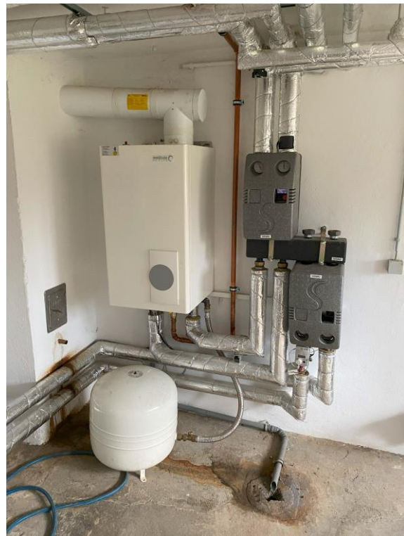
Bild 21, im Haus Nr. 10 befindliche Heizung für das Gesamtobjekt
