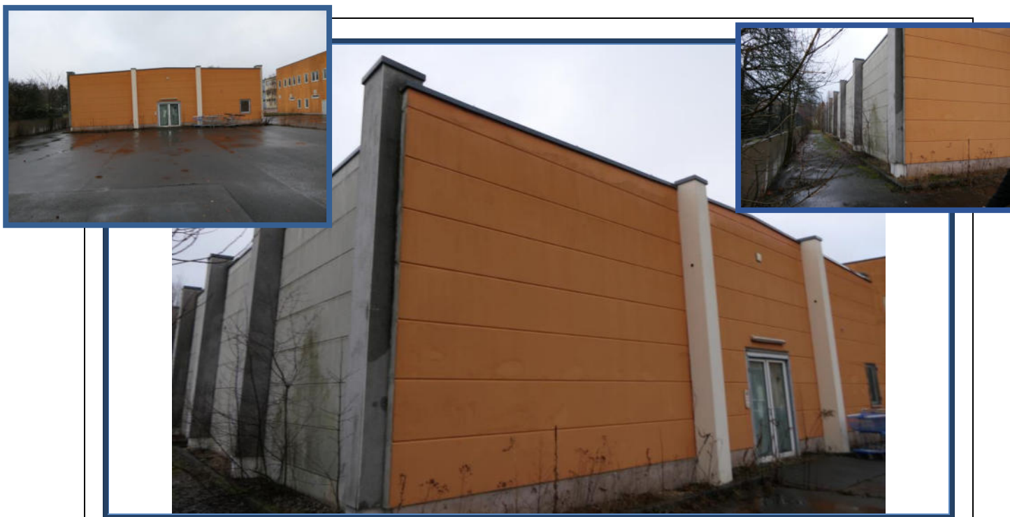
Abbildung 19: Nord-West-Ansicht des Einzelhandelsgebäudes (Rück-/Seitenansicht); verwilderte Außenanlagen
