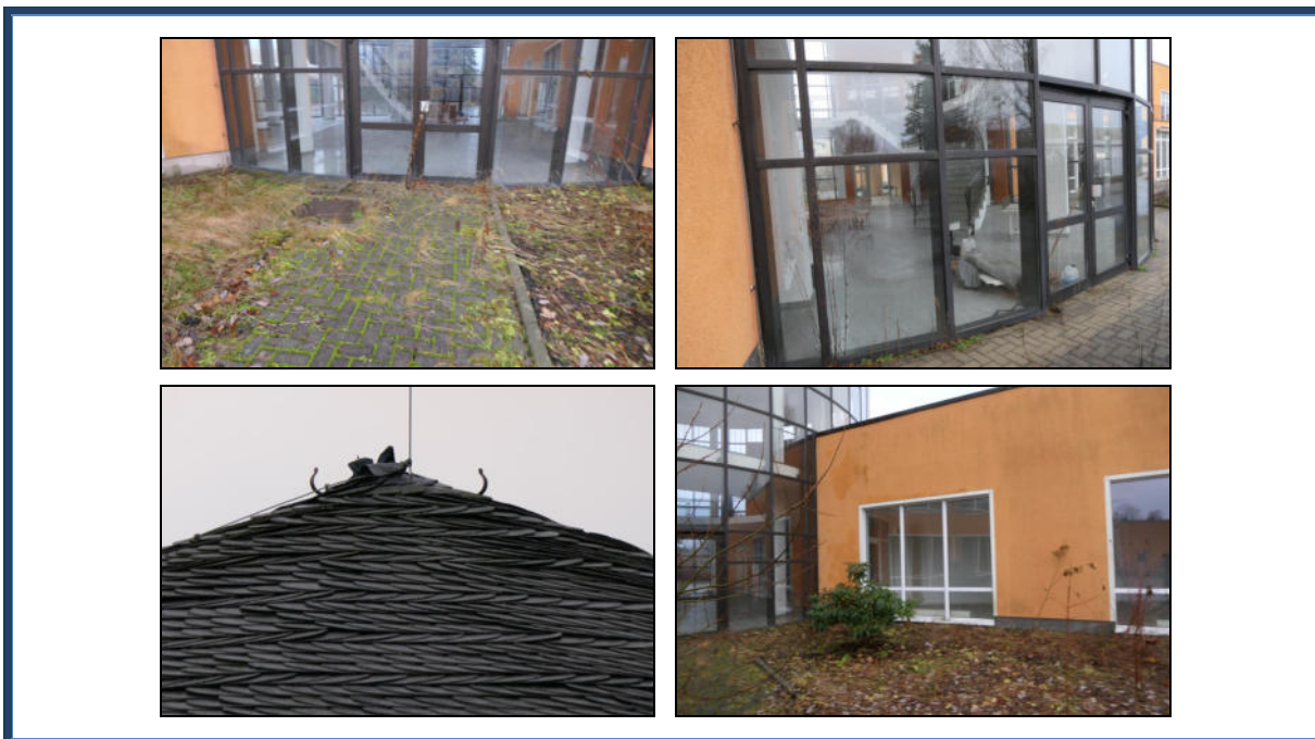
Abbildung 16: Detailansichten des Einkaufszentrums (Eingangsbereiche; Dacheindeckung); verwilderte Außenanlagen
