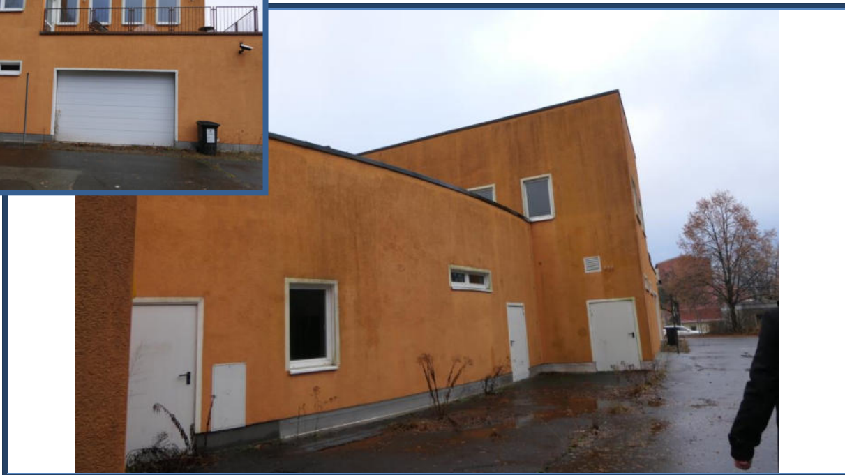
Abbildung 8: West-Ansicht des Einkaufszentrums (Seiten-/Rückansicht); verwilderte Außenanlagen
