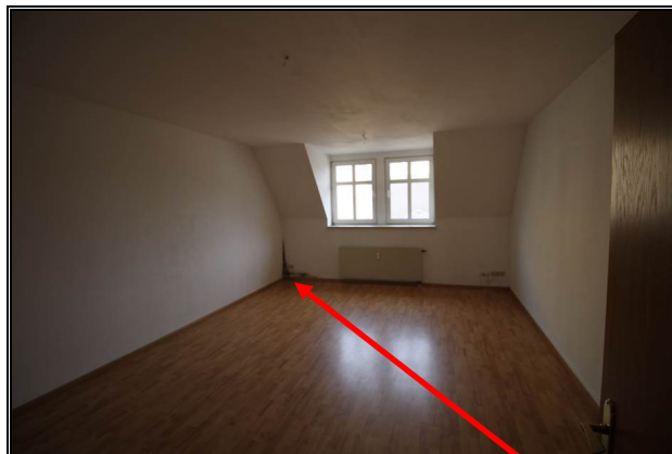
sichtbare Schimmelbildung in der Zimmerecke und den Fensterlichtern (Wohnzimmer)
