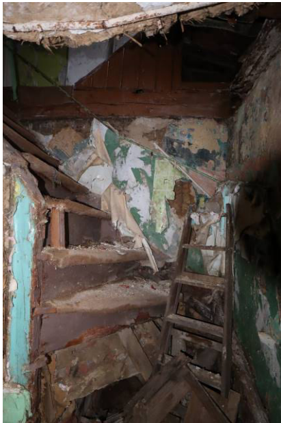
Detailansicht der eingebrochenen Decke zum Obergeschoss
