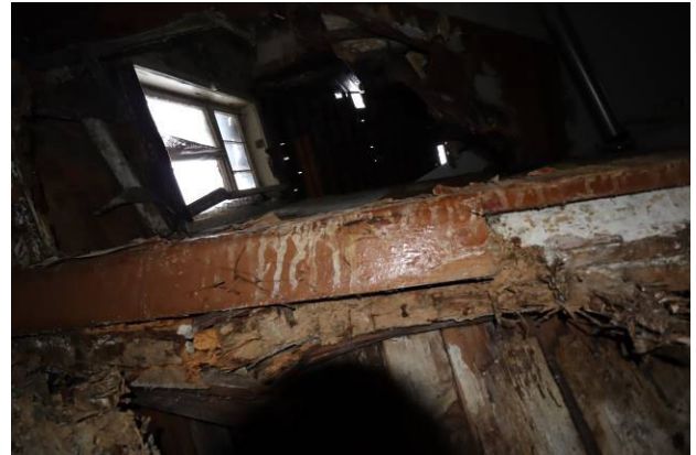
Blick ins Obergeschoss durch die eingebrochene Decke
