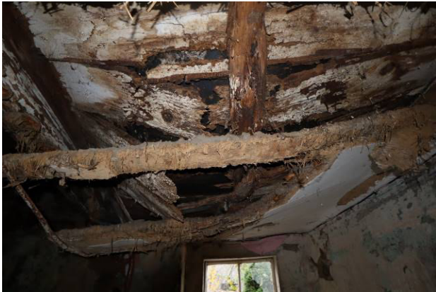
Detailansicht der eingebrochenen Decke
