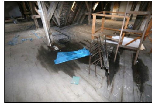
Blick auf eine größere Durchfeuchtung des Holzfußbodens aufgrund undichter Stellen am Dach
