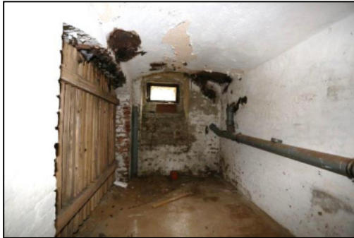
Blick in einen Kellerbereich mit Schimmelbefall
