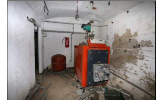
Blick in den Heizraum. Im gesamten Keller wurden Heizungsrohre und Kabel der Elektroinstallation gestohlen bzw. zerstört
