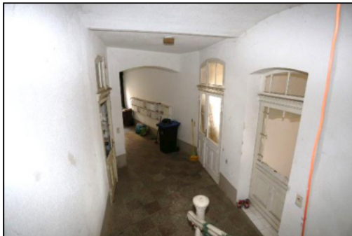
Blick in das Treppenhaus im Erdgeschoss. An vielen Wohnungstüren ist die Verglasung beschädigt
