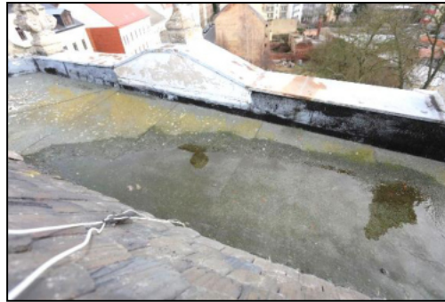
Blick auf einen Flachdachbereich, bei welchem das Wasser nicht mehr abfließt
