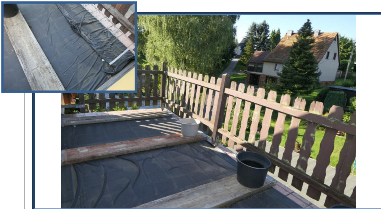
Abbildung 23: Terrasse im Dachgeschoss; beschädigter Terrassenbelag und beschädigte Holzbauteile; umliegende Bebauung
