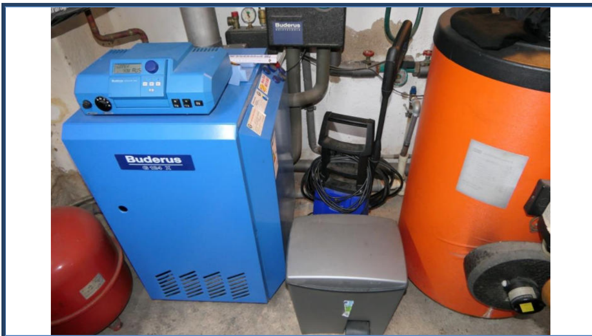
Abbildung 10: Heizungsanlage im Kellergeschoss
