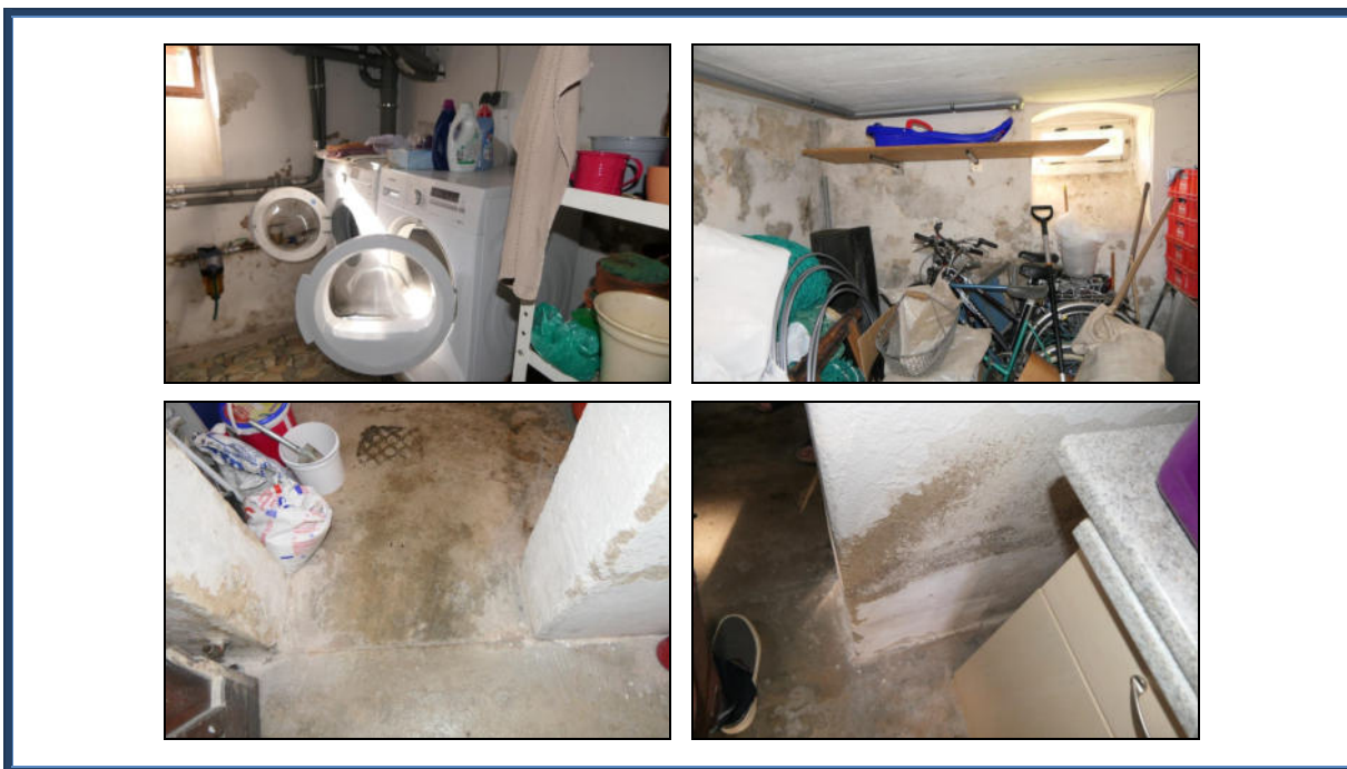
Abbildung 9: Kellerräume; bauartypische Feuchtigkeitsproblematik
