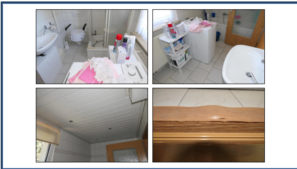
Abbildung 17: Badezimmer im Obergeschoss; ein Feuchtigkeitsschaden an dem Türrahmen und an der Deckenbekleidung durch die Beschädigungen am Flachdach (Terrasse)
