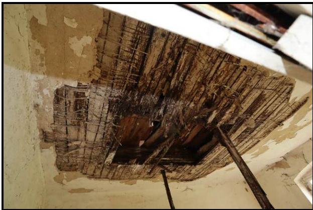
Detailansicht durchgebrochene Decke im Wohnhaus
