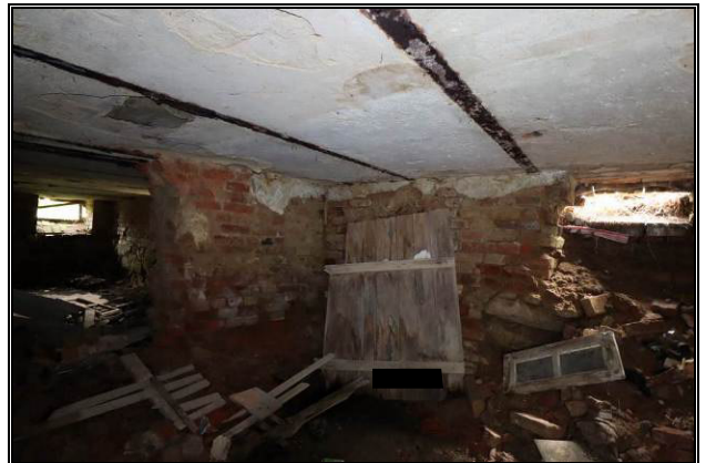
zusammenfallendes Mauerwerk im Keller
