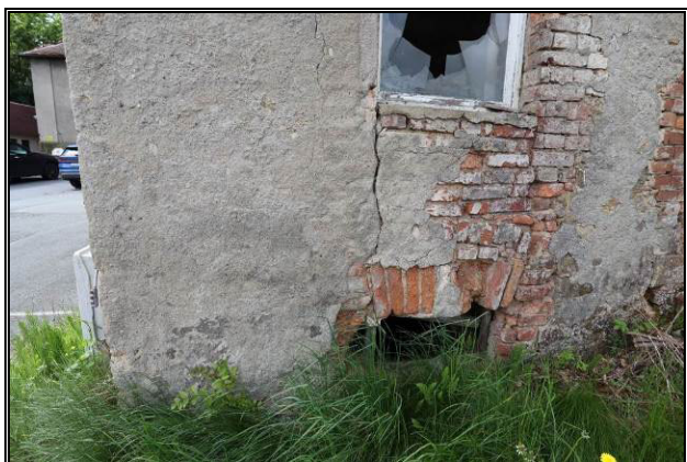
Detailansicht Mauerwerksriss am ehem. Wohnhaus (straßenseitig)
