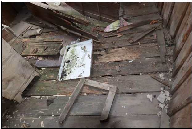
durchbrechende Dielung im Dachboden
