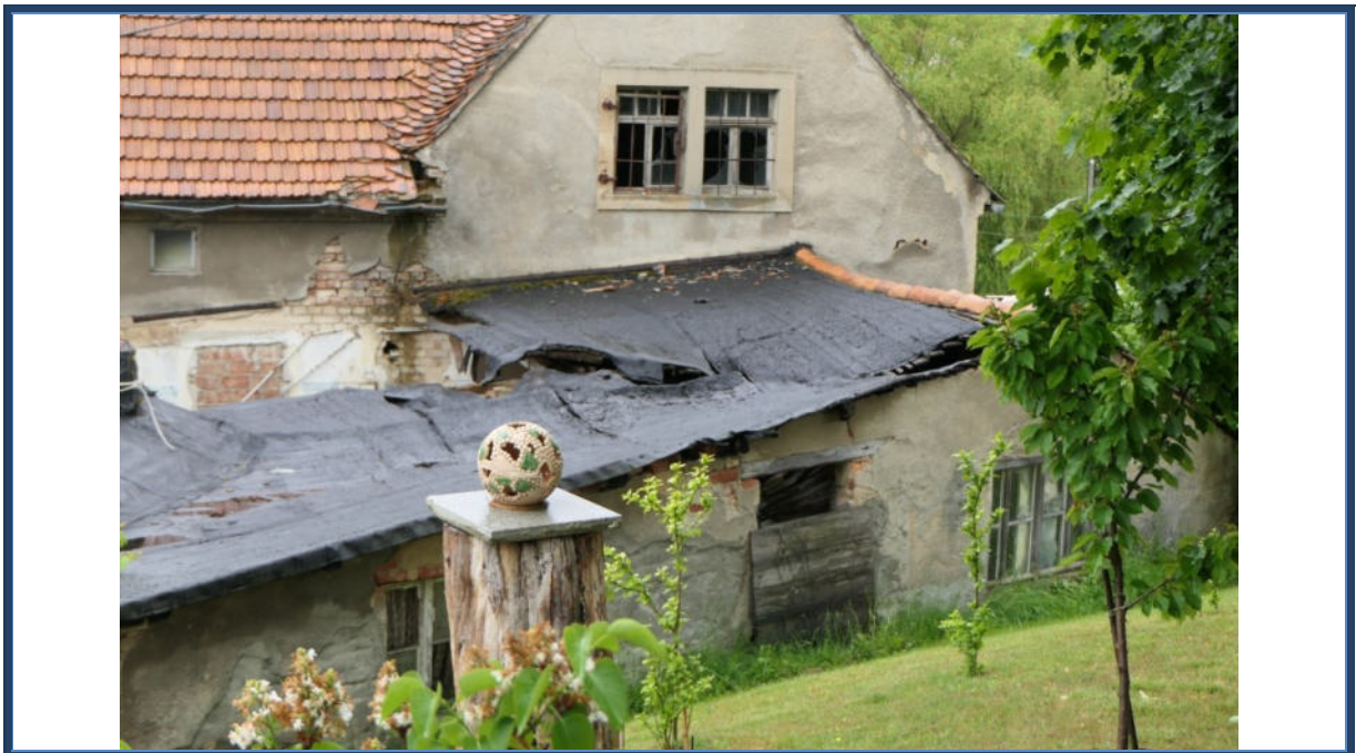
Abbildung 14: Detailansicht des bereits eingestürzten Anbau/-Zwischenbau
