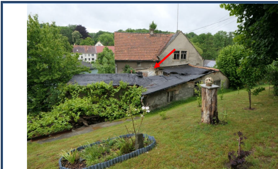
Abbildung 4: Ost-Ansicht; im Vordergrund der Anbau-/Zwischenbau (tlw. bereits eingestürzt); dahinter das Hauptgebäude; umliegende Bebauung und Nutzung
