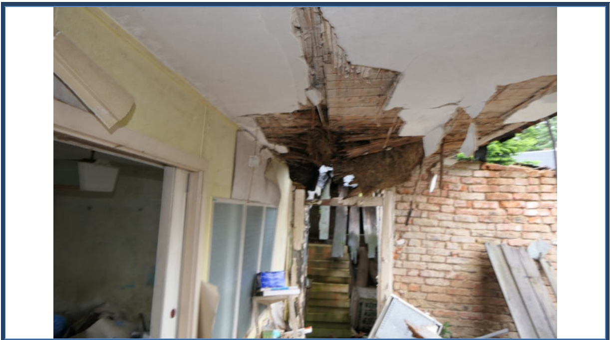
Abbildung 10: Blick vom Obergeschoss des Hauptgebäudes zum Anbau/-Zwischenbau; bereits großflächig eingestürzt
