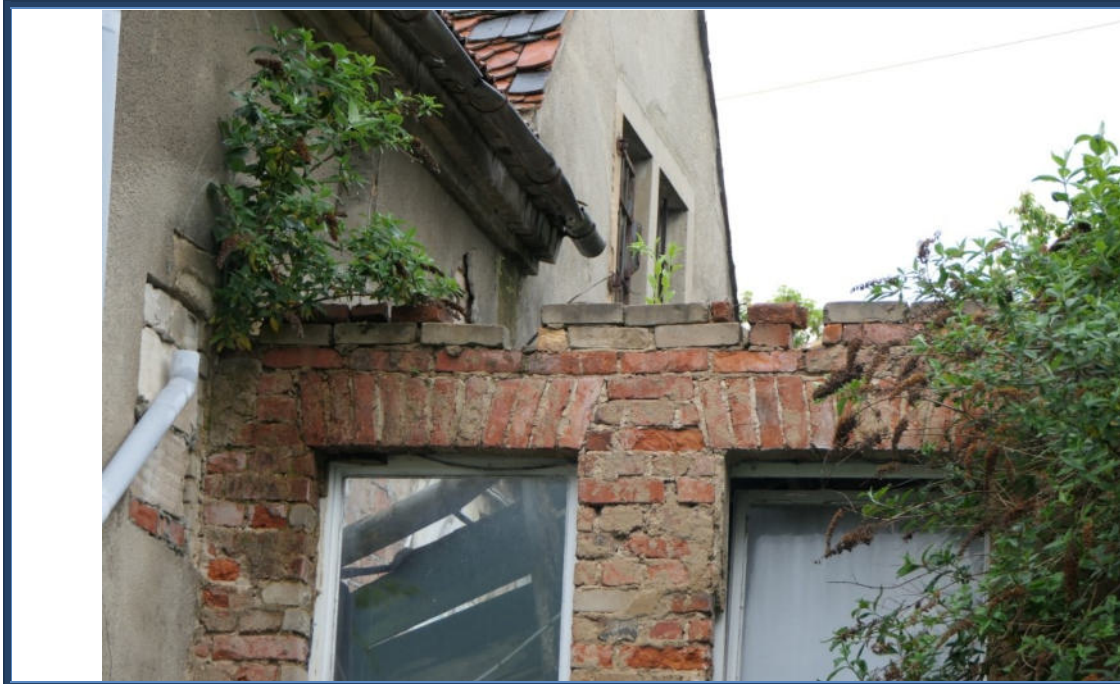
Abbildung 11: Detailansicht des bereits eingestürzten Anbau-/Zwischenbau
