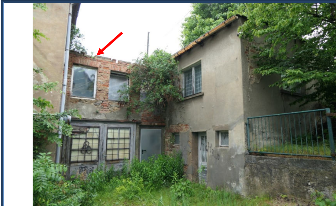
Abbildung 3: Seitenansicht (Süd-Ost-Ansicht); links das Hauptgebäude; rechts der Anbau-/Zwischenbau (tlw. bereits eingestürzt); Außenanlagen
