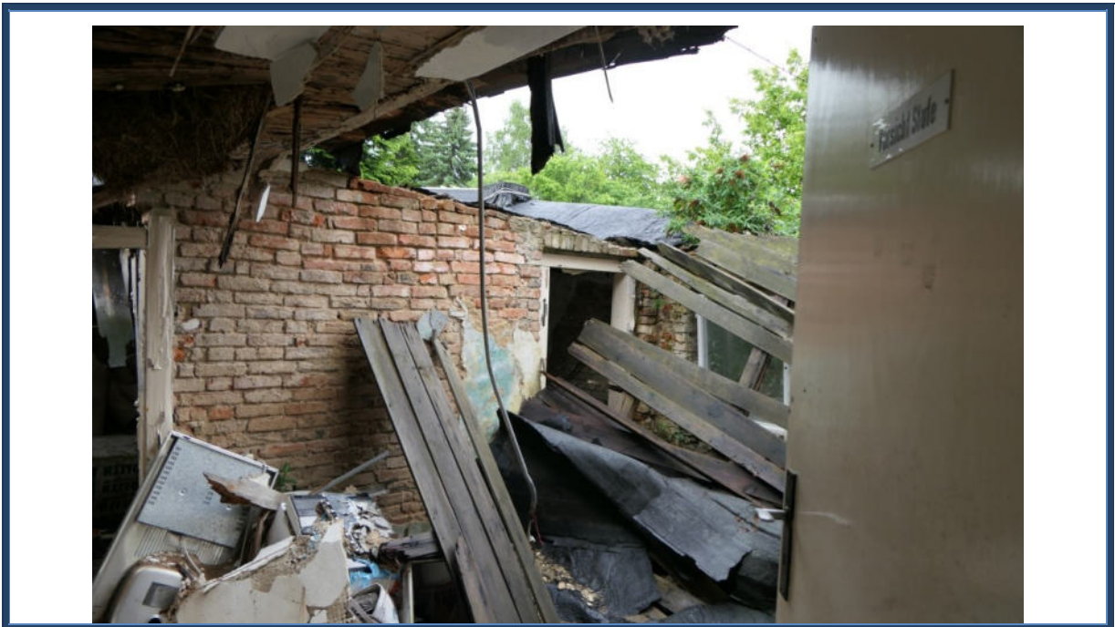
Abbildung 9: Blick vom Obergeschoss des Hauptgebäudes zum Anbau/-Zwischenbau; bereits großflächig eingestürzt
