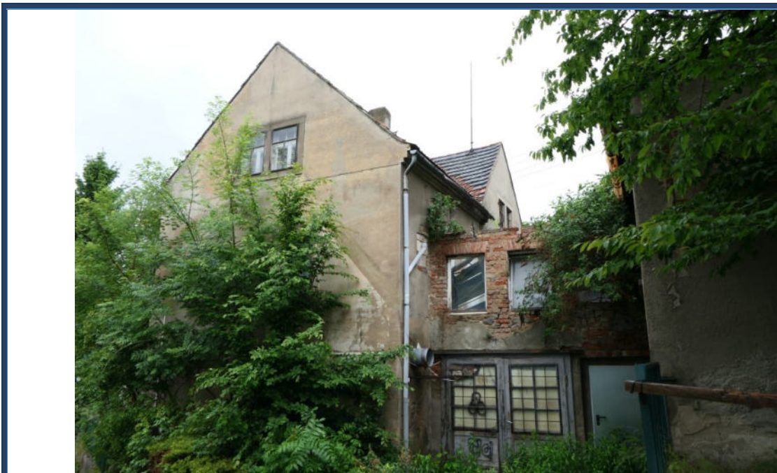
Abbildung 2: Seitenansicht (Süd-Ost-Ansicht; Blick von der Straße „Am Sportplatz“); links das Hauptgebäude; rechts der Anbau-/Zwischenbau (tlw. bereits eingestürzt)
