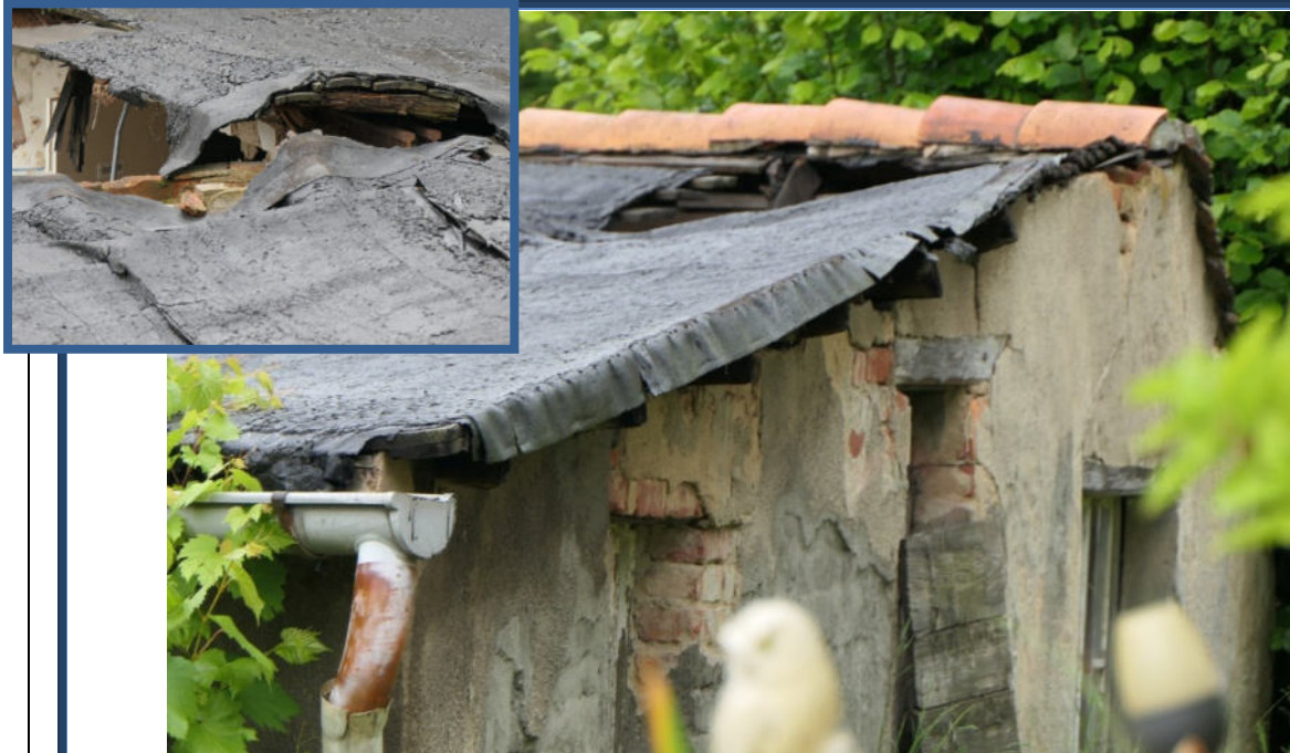
Abbildung 15: Detailansichten des bereits eingestürzten Anbau-/Zwischenbau
