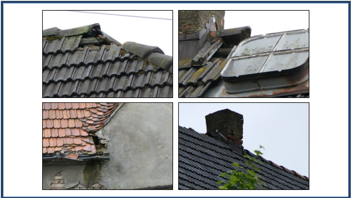
Abbildung 13: Detailansichten der Schäden an der Dacheindeckung
