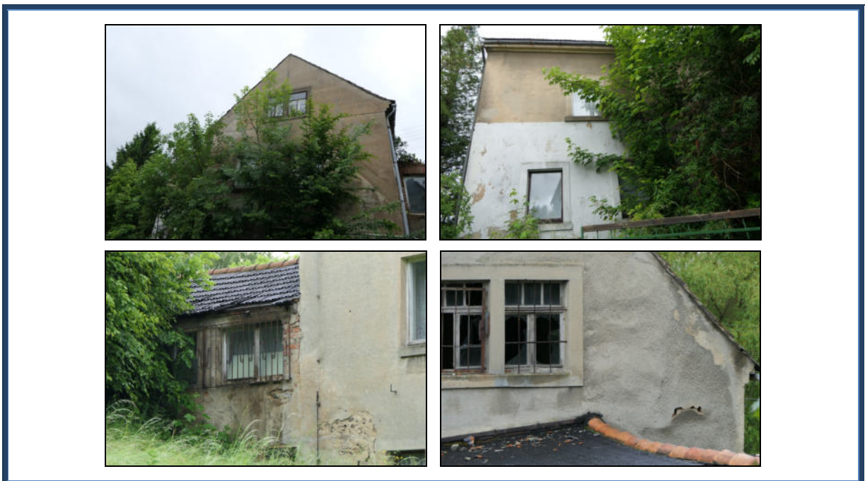
Abbildung 12: Detailansichten der Schäden an der Fassade
