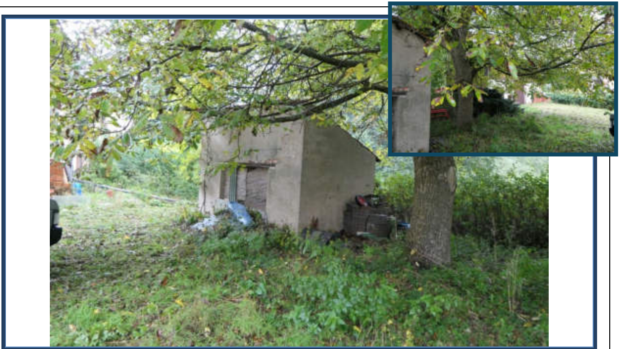
Abbildung 15: Außenanlagen im nördlichen Grundstücksbereich von Flurstück 148; ein abrisssreifes einfaches Nebengebäude
