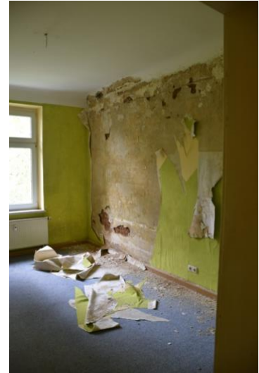
Foto 10: Schaden durch Nässe
