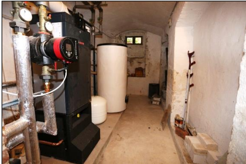
Blick in den Heizungsraum.
