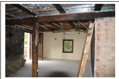
Ansicht eines Raumes im Obergeschoss nach dem Brand.
