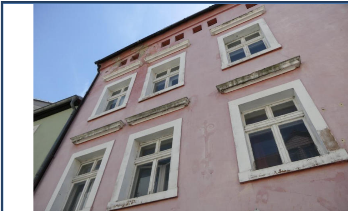
Abbildung 4: Detailansichten: Schäden an der Fassade
