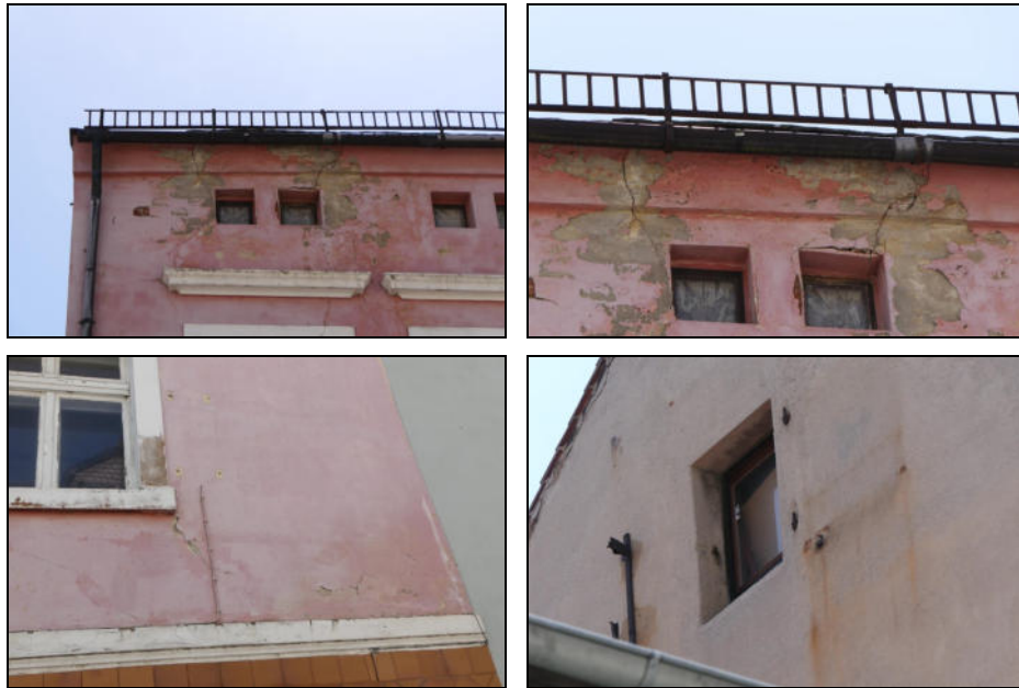
Abbildung 5: Detailansichten: Schäden an der Fassade
