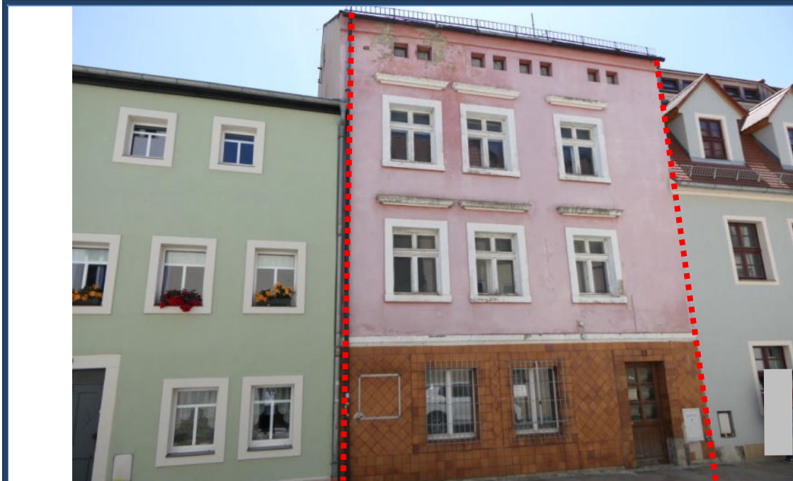
Abbildung 1: Straßenansicht (Nord-Ansicht); angrenzende Bebauung; Beschädigungen an der Fassade
