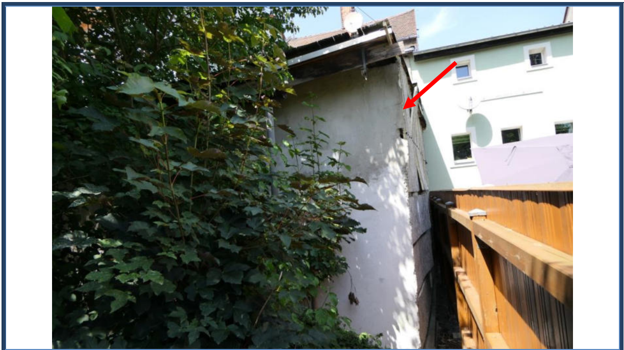
Abbildung 8: Rückansicht der Anbauten; stark verwilderte und beschädigte Außenanlagen; benachbarte Bebauung
