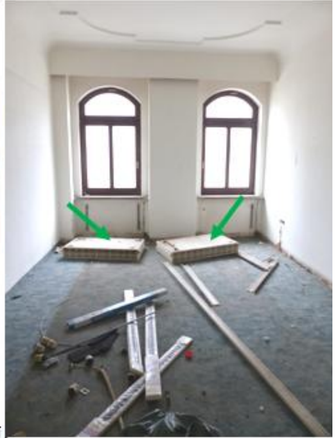
Vandalismus (abgerissene Heizkörper) in Wohn. Nr. 1
