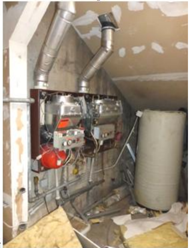
zerstörte Zentralheizungsanlage im Dachgeschoss
