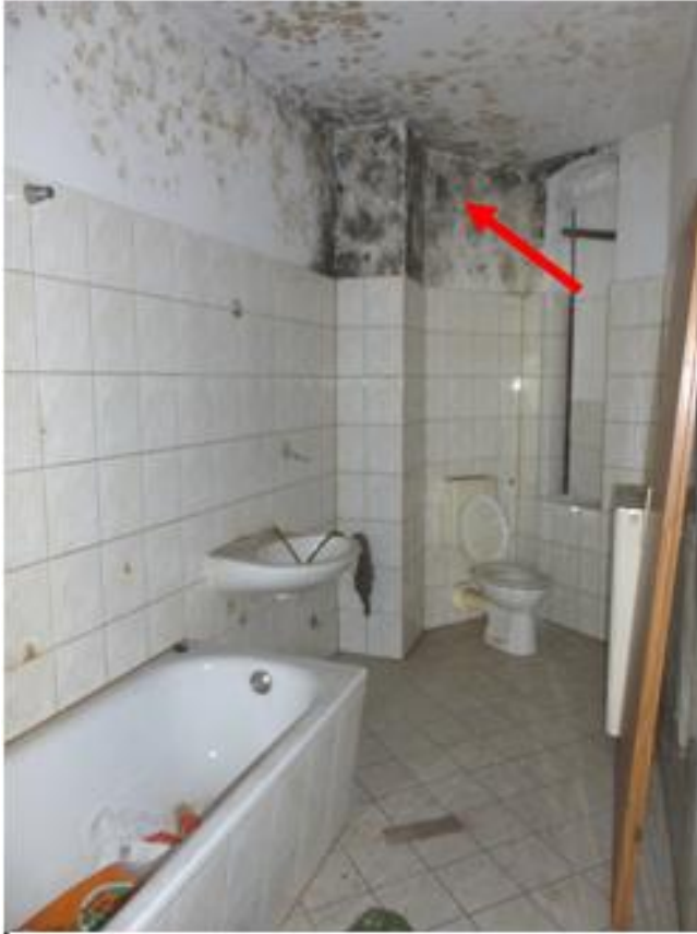
Bad Wohnung Nr. 1 mit Schimmelbefall (rot)
