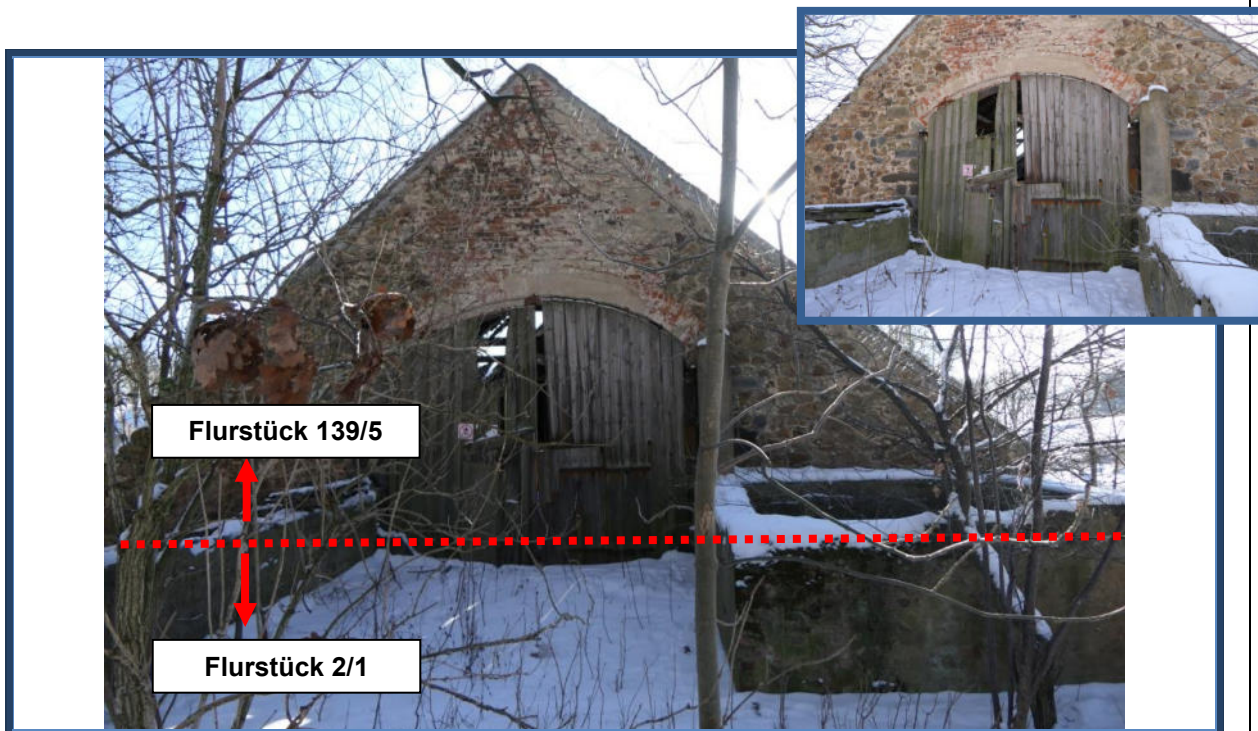
Abbildung 6: Nord-Ansicht (Seitenansicht); stark beschädigtes Einfahrtstor; rückseitige Zufahrt zum Scheunengebäude und Silo o. ä. sowie verwilderte und beschädigte Außenanlagen auf dem benachbarten Flurstück 2/1
