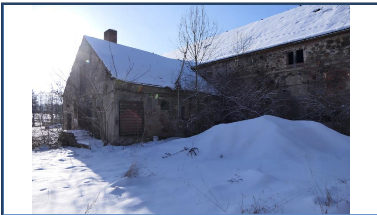
Abbildung 14: Verwilderte und beschädigte Außenanlagen im östlichen Grundstücksteil
