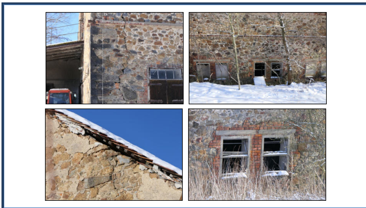
Abbildung 10: Detailansichten der Schäden am Gebäude (tlw. starke Rissbildung); beschädigte und notgesicherte Fenster; beschädigte Dacheindeckung
