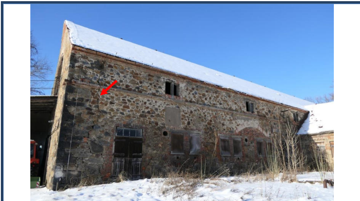
Abbildung 2: Ost-Ansicht (Vorderansicht); rechts der Scheunenanbau; tlw. starke Rissbildung; verwilderte Außenanlagen
