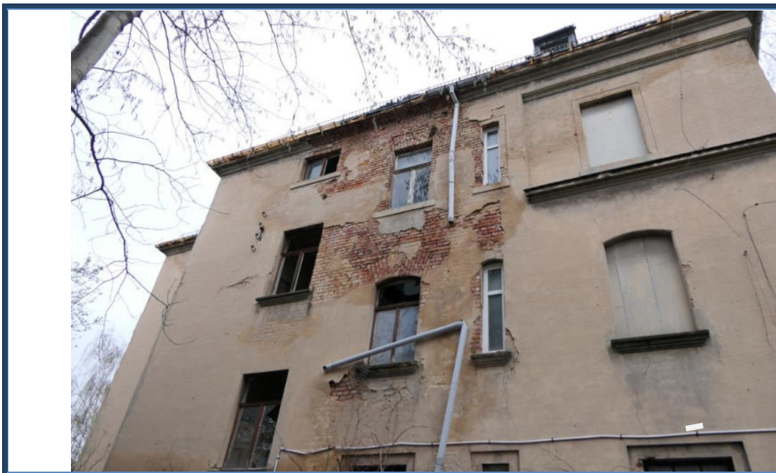
Abbildung 3: Seitenansicht (Süd-Ansicht); starke Beschädigungen an der Fassade und der Dachentwässerung
