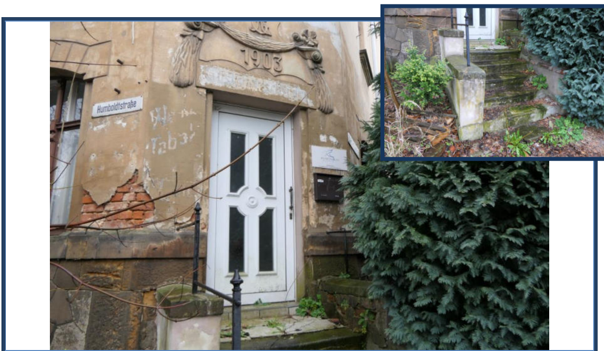
Abbildung 12: Eingangsbereich zur ehemaligen Gewerbeeinheit an der Gebäudeostseite; stark beschädigt; Außenanlagen
