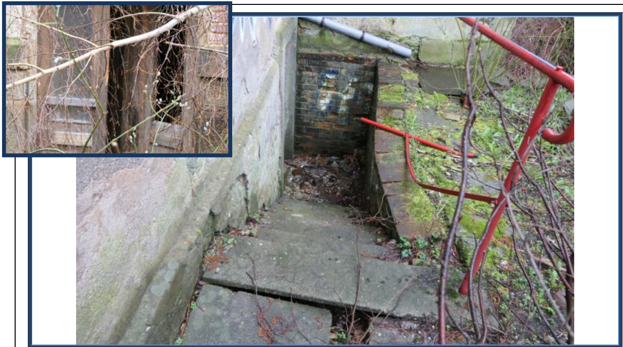
Abbildung 13: Kelleraußenzugang; Miniaturbild: Hauseingang; stark beschädigte Außenanlagen
