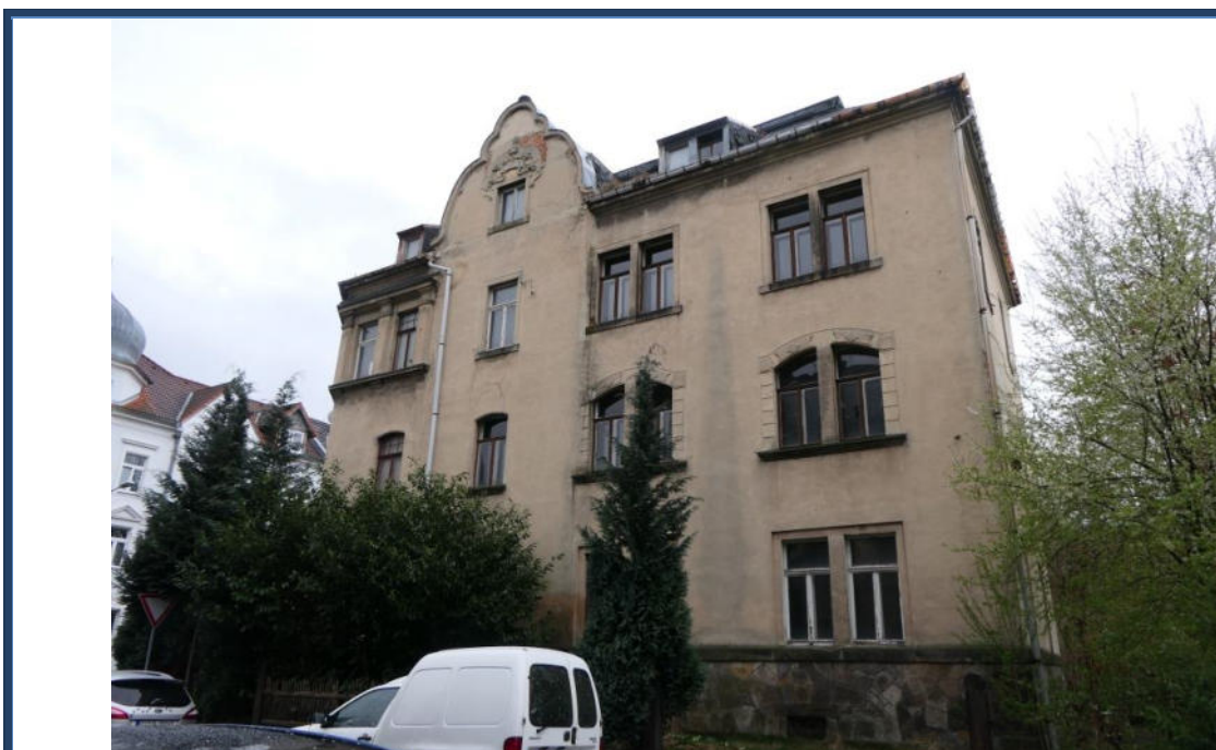
Abbildung 6: Seitenansicht (Nord-Ansicht); verwilderte und beschädigte Außenanlagen; umliegende Bebauung
