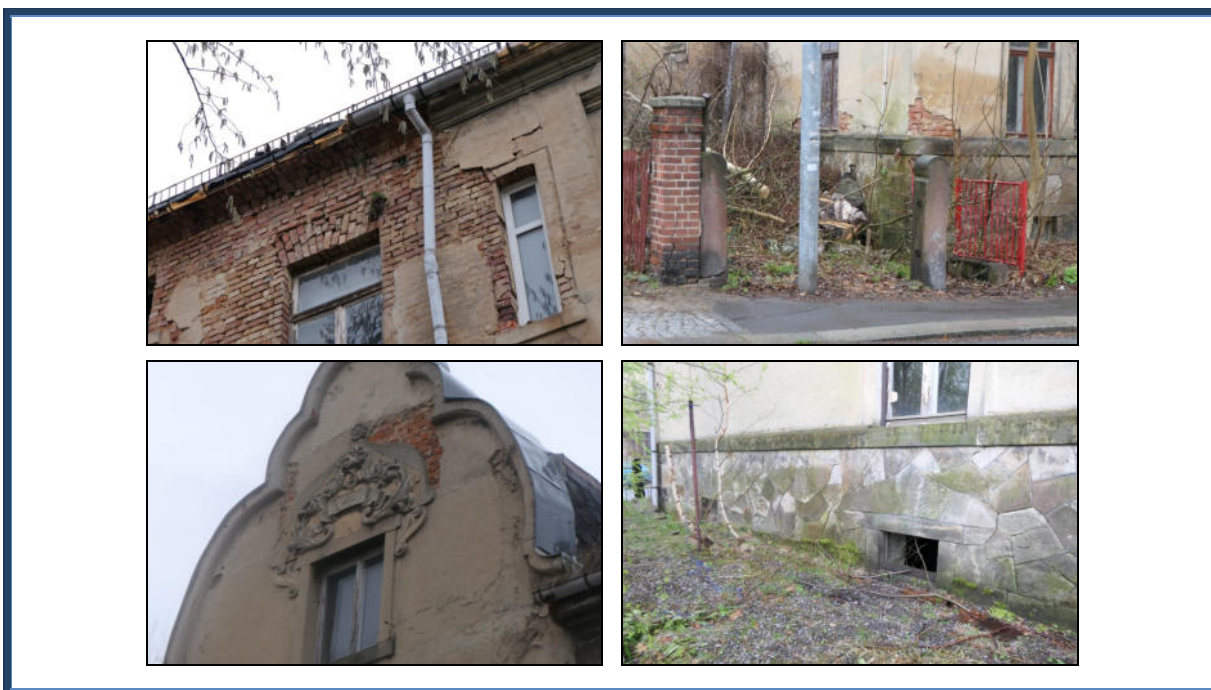
Abbildung 8: Detailansicht: Beschädigungen an der Fassade
