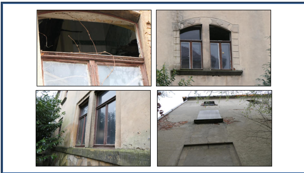
Abbildung 11: Detailansichten: stark beschädigte Fenster; tlw. notgesichert
