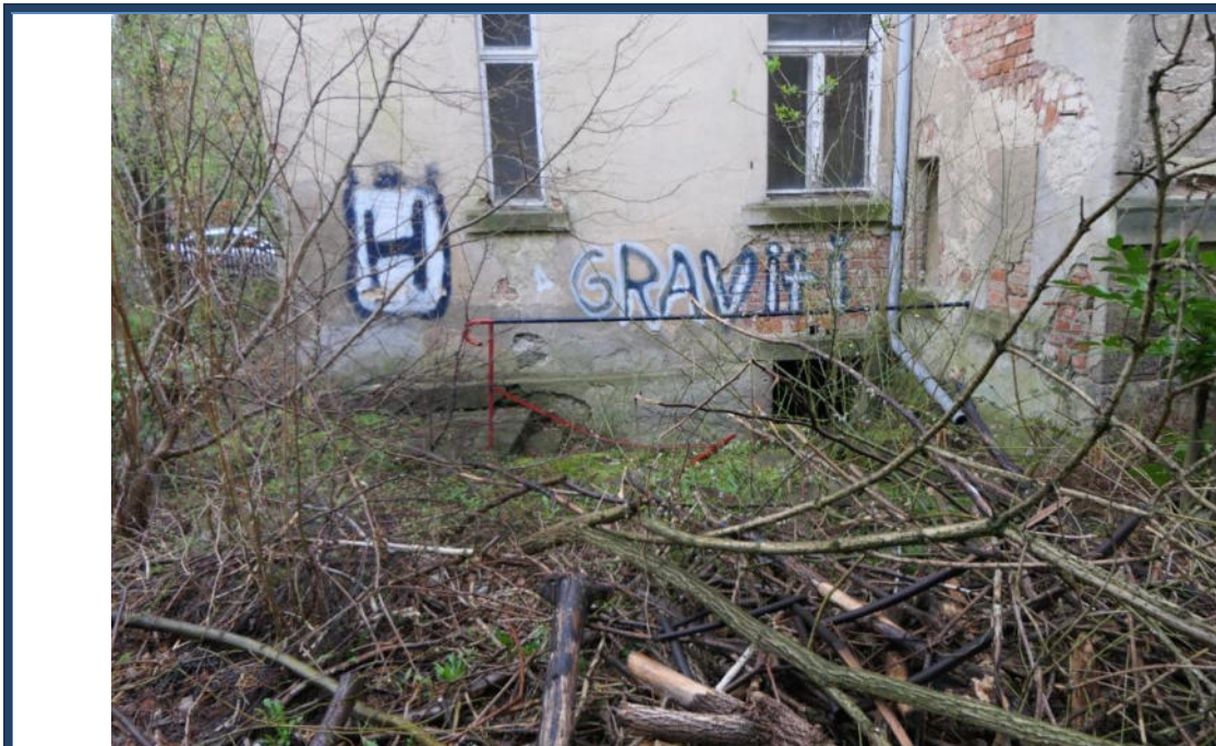
Abbildung 17: Stark verwilderte und beschädigte Außenanlagen im rückseitigen Grundstücksbereich
