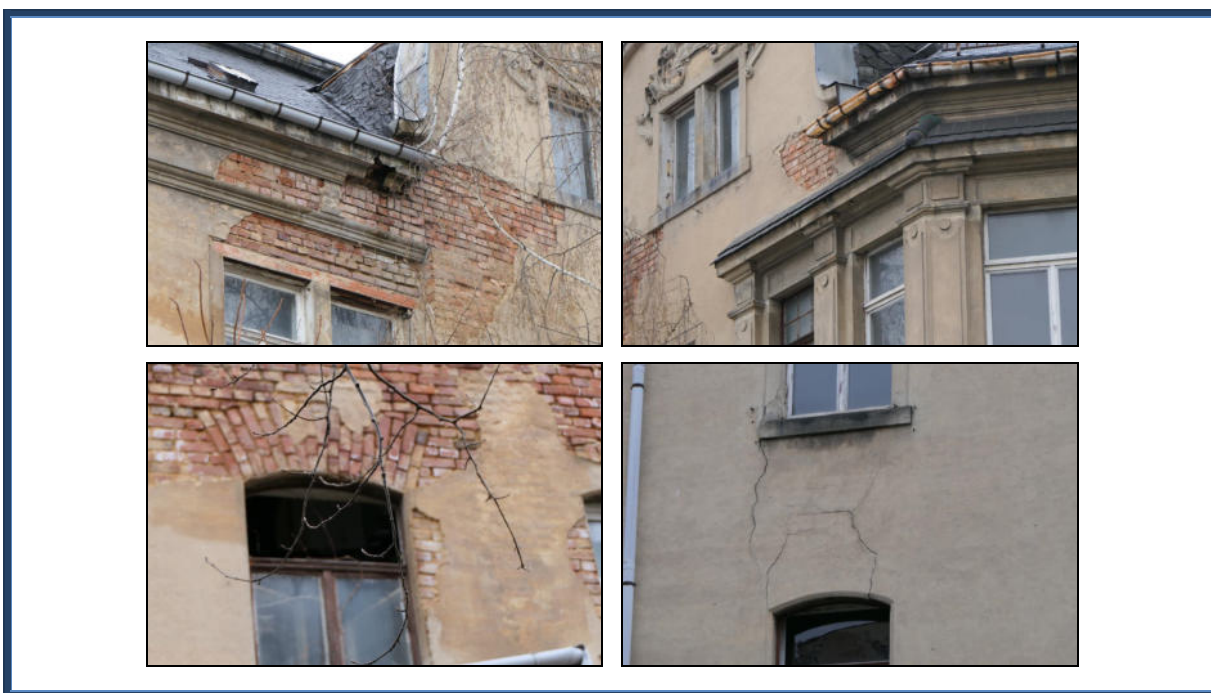
Abbildung 7: Detailansicht: Beschädigungen an der Fassade
