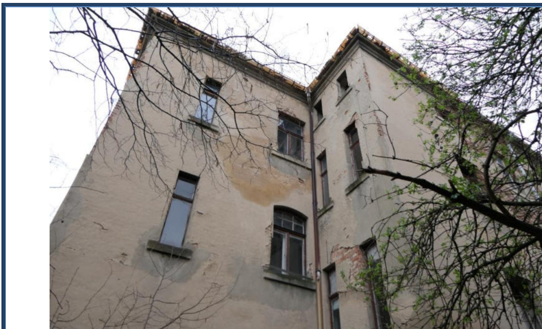
Abbildung 4: Seitenansicht (Süd-Ansicht); starke Beschädigungen an der Fassade und der Dachentwässerung
