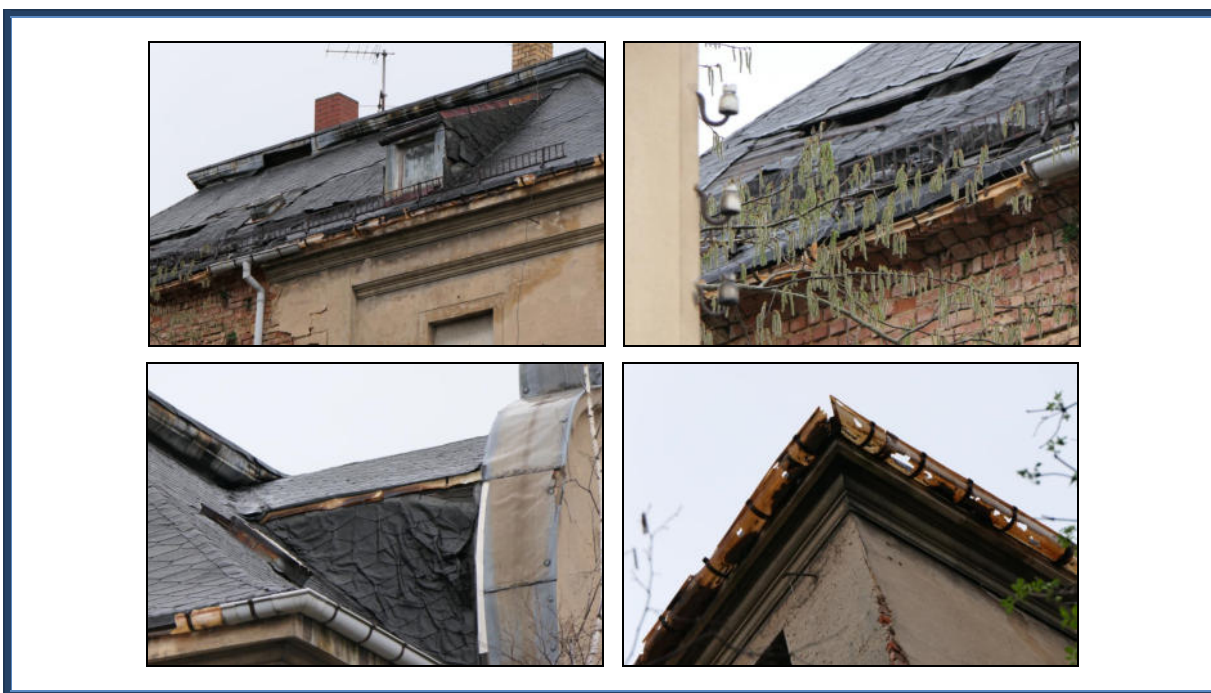
Abbildung 9: Detailansichten: Schäden an der Dacheindeckung und an der Dachentwässerung
