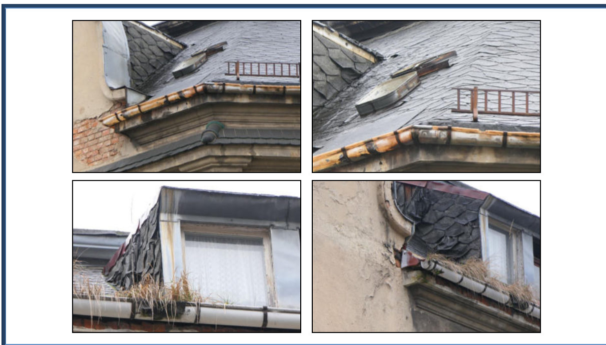
Abbildung 10: Detailansichten: Schäden an der Dacheindeckung und an der Dachentwässerung; eine offenstehende Dachluke
