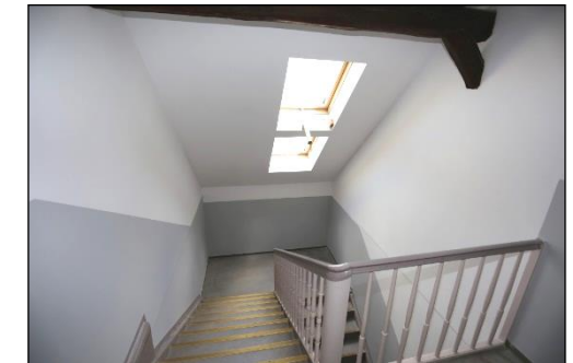
Im Dachgeschoss des Treppenhauses ist eine Rauch- und Wärmeabzugsanlage angeordnet.
