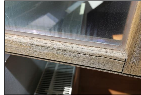
Die Holzfenster und die Holzverkleidungen der Gauben wiesen einen verwitterten Zustand auf.
