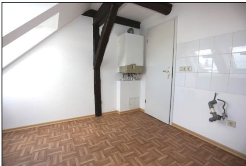
In der Küche ist die defekte Gasetagenheizung und ein Waschmaschinenanschluss angeordnet.
