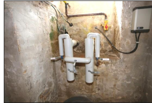
Der Kellerraum der Wohnung W 8 dient gleichzeitig als Hausanschlussraum.
