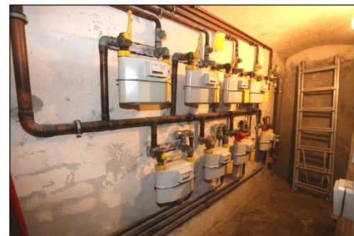
Im Bereich des Treppenabganges sind die Gaszähler der einzelnen Einheiten angeordnet.
