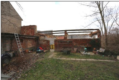
Blick aus östlicher Richtung auf die ruinöse Scheune. Links ist die Garage angeordnet.
