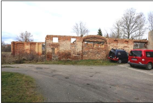
Blick in nördliche Richtung auf eine ruinöse Scheune (nur rechter Gebäudeteil)
