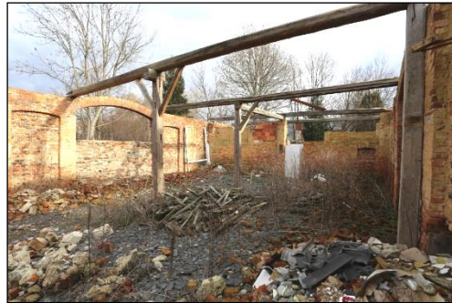
Blick in das Gebäudeinnere der ruinösen Scheune
