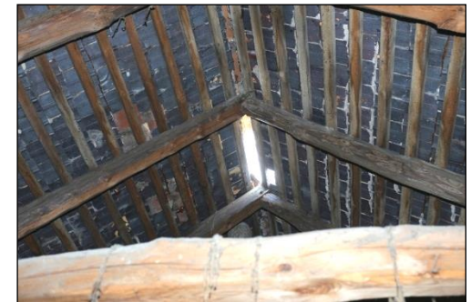
zahlreiche Fehlstellen im Dachbelag sind hier vor allem im Firstbereich vorhanden
