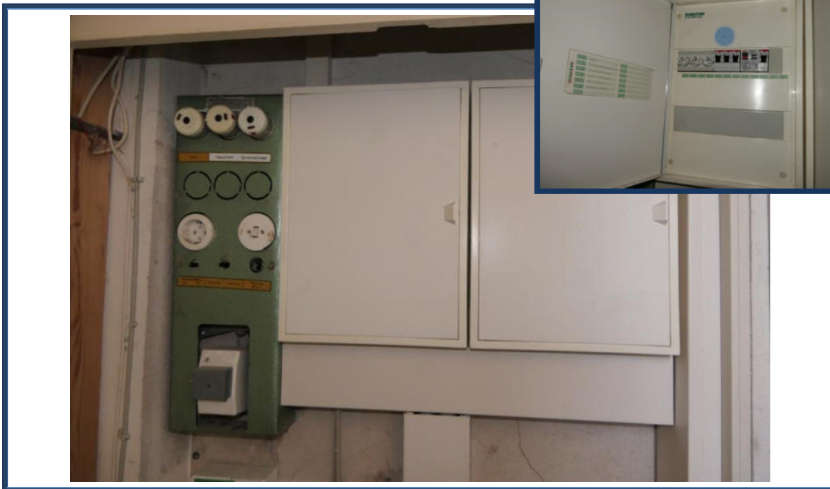
Abbildung 21: Tlw. überalterte Elektroinstallation
