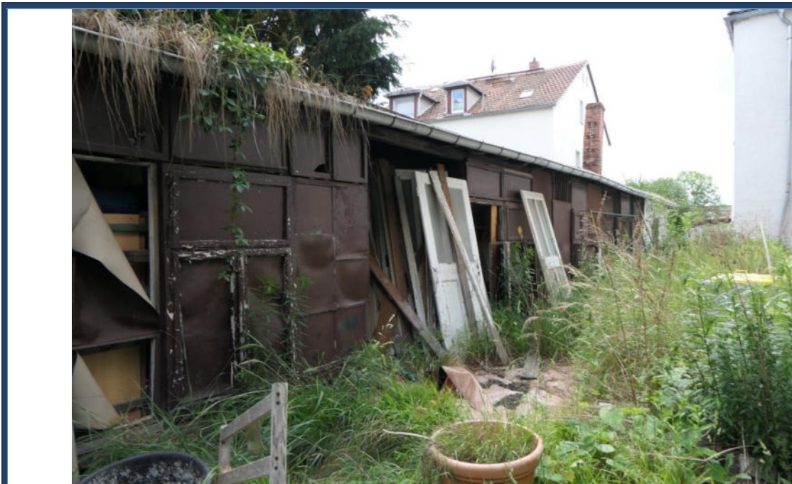
Abbildung 23: Abbruchreifes Waschhaus mit Schuppen; Blick in westliche Richtung; verwilderte Außenanlagen; Unratablagerungen
