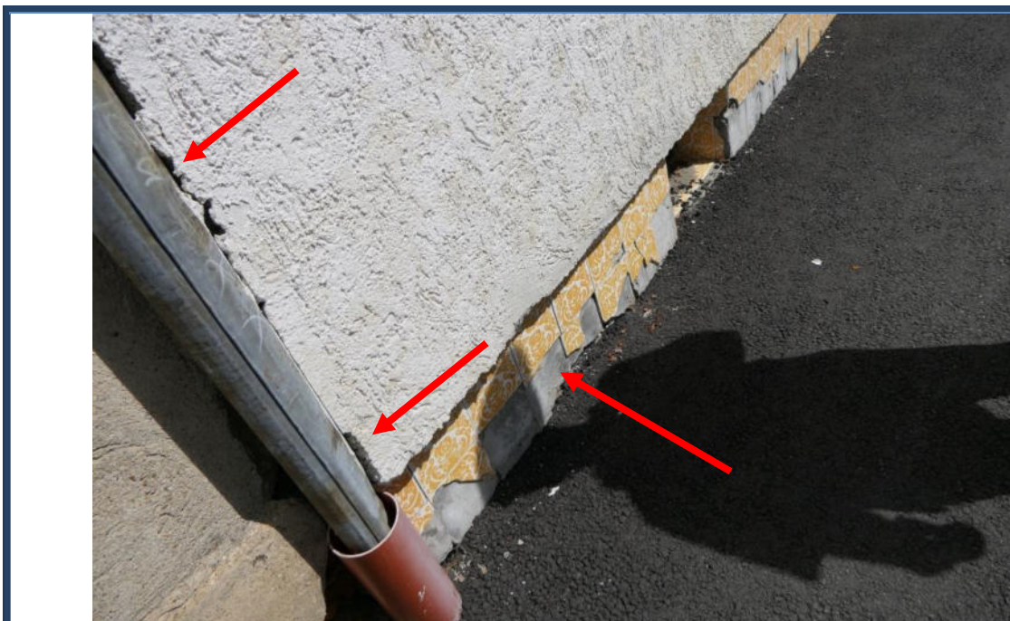
Abbildung 8: Vordergebäude: Detailansicht (Schäden im Sockelbereich und nicht fachmännisch angebrachte Wärmedämmung)
