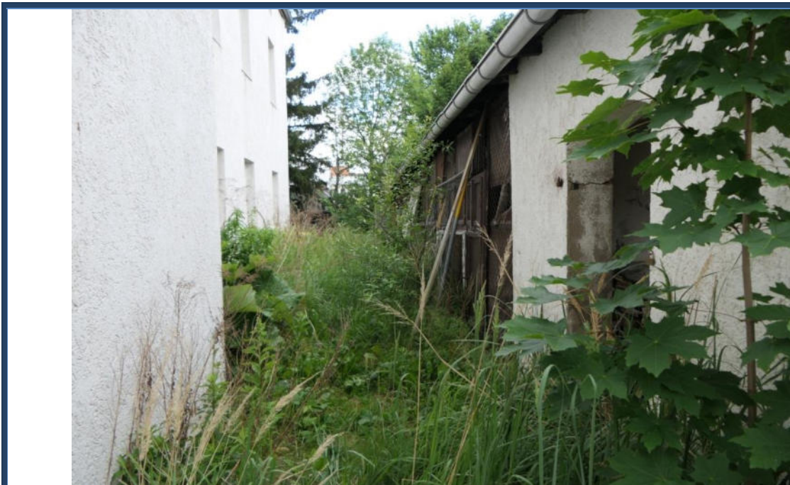
Abbildung 25: Bereich zwischen dem Hintergebäude und dem abbruchreifen Waschhaus mit Schuppen; Blick in östliche Richtung; stark verwilderte und vernachlässigte Außenanlagen
