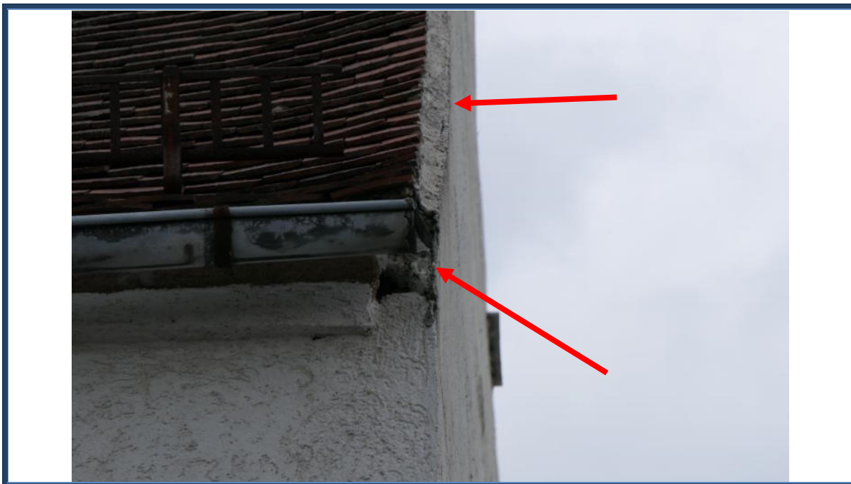
Abbildung 9: Vordergebäude: Detailansicht (nicht fachmännisch angebrachte Wärmedämmung)
