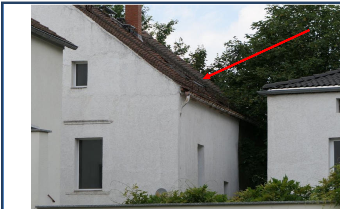
Abbildung 11: Links das Vordergebäude: Detailansicht (Dachkonstruktion uneben); rechts das Hintergebäude; Südansichten
