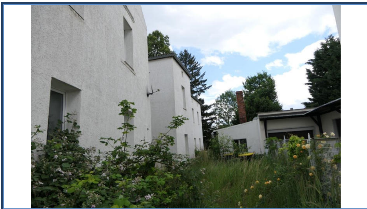
Abbildung 17: Blick in östliche Richtung; links das Vordergebäude, dahinter das Hintergebäude; mittig das abbruchreife Waschhaus mit Schuppen; stark verwilderte und vernachlässigte Außenanlagen
