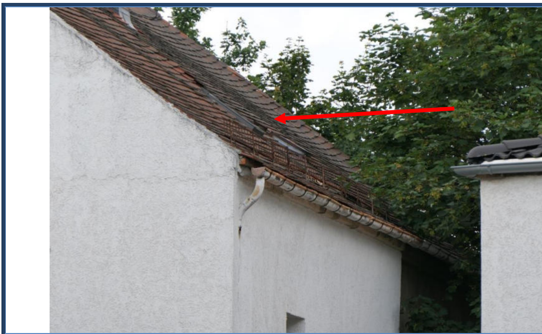
Abbildung 12: Links das Vordergebäude: Detailansicht (Dachkonstruktion uneben); rechts das Hintergebäude; Südansichten
