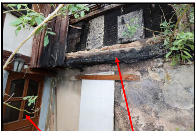
Hauseingang; sichtbarer Brandschaden
