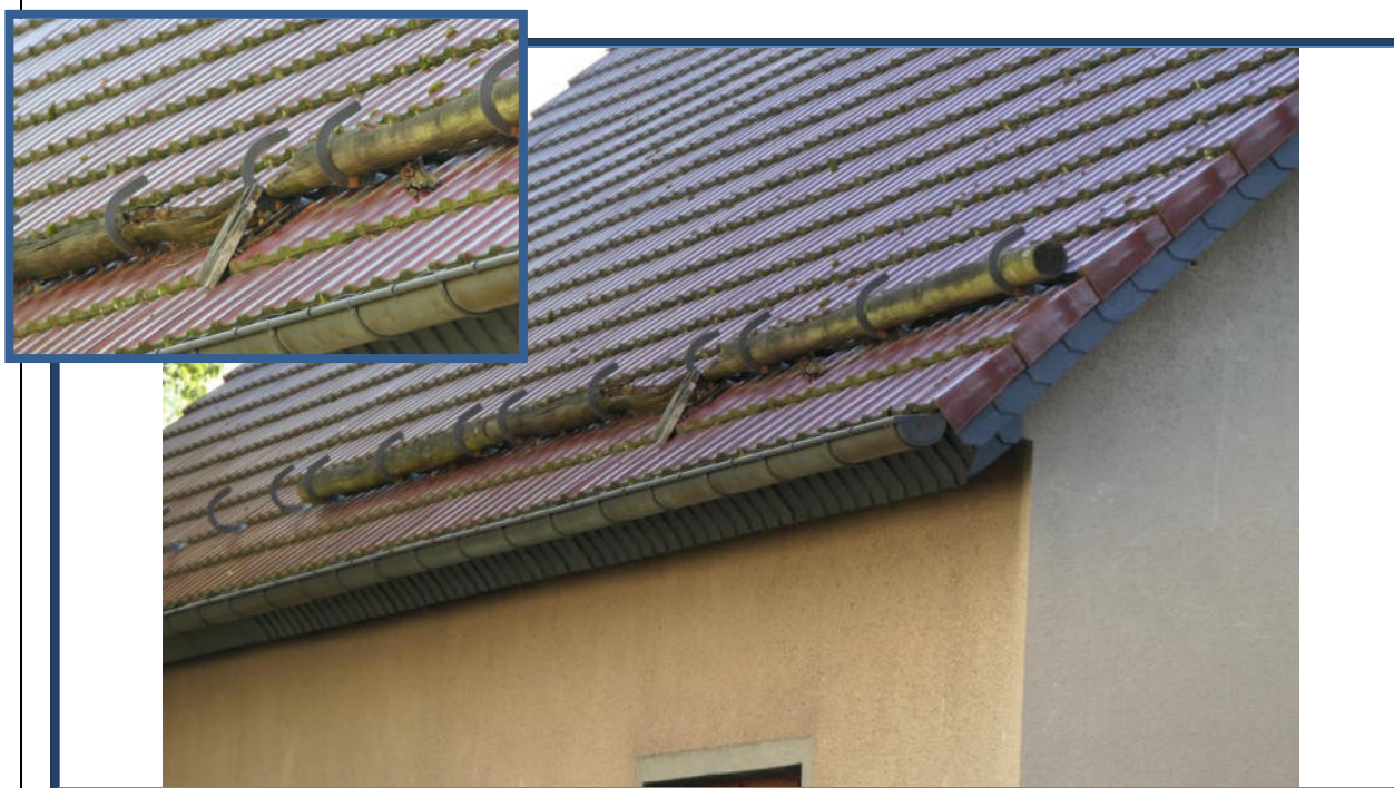
Abbildung 12: Detailansichten der Dacheindeckung; beschädigter Schneefang
