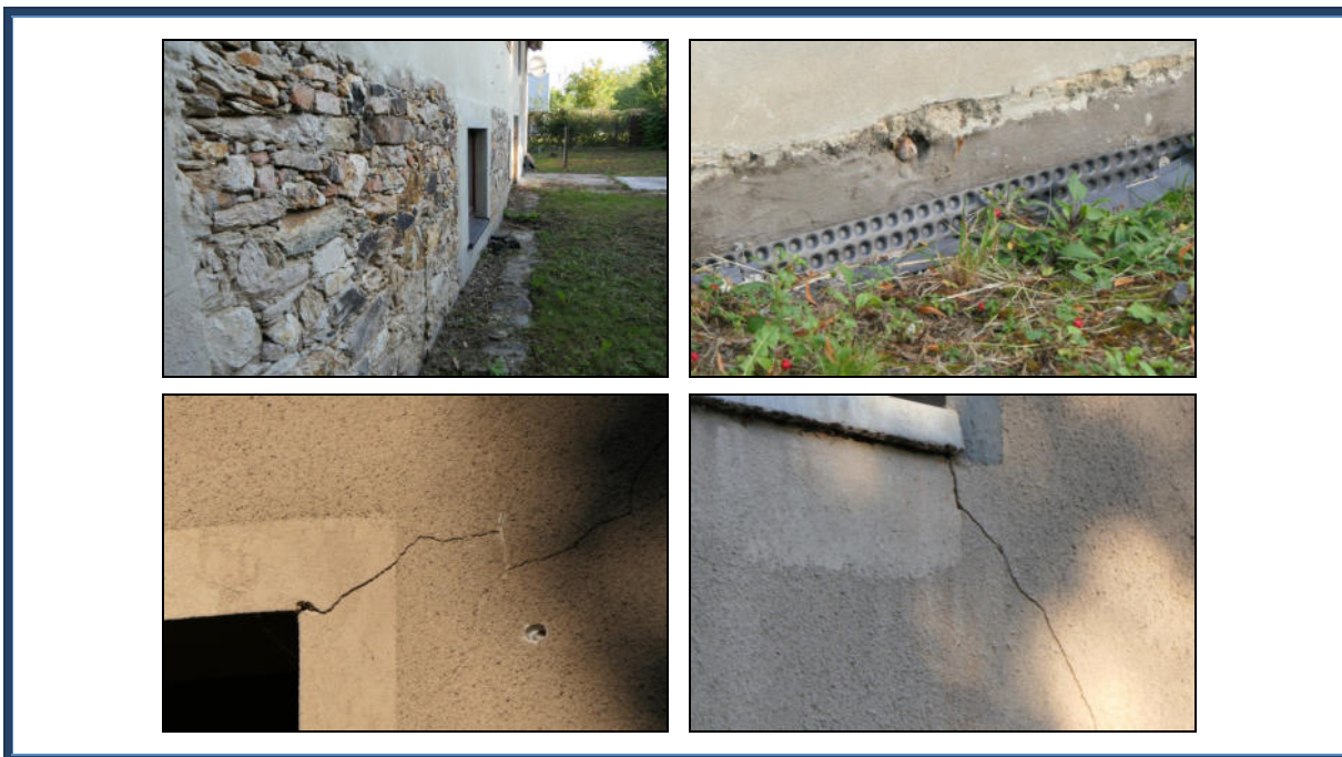
Abbildung 10: Detailansichten der Beschädigungen an der Fassade
